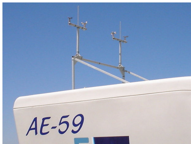
Imagen 5: Antenas de comunicaciones del aerogenerador con el sistema de control de parque
