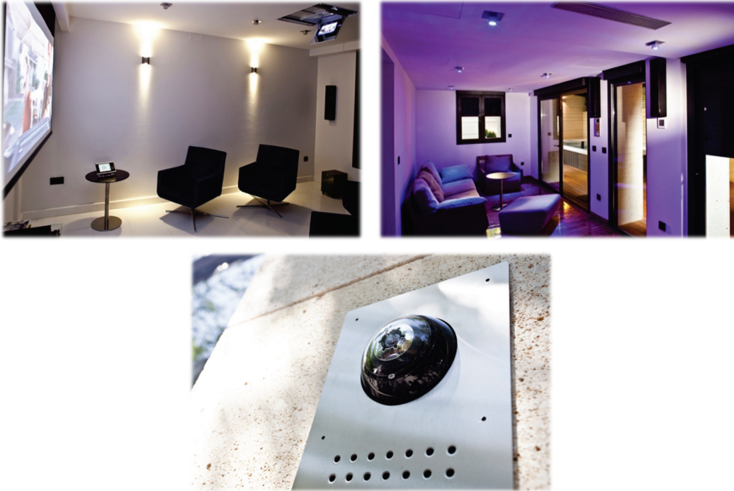
Figura 1.2 Instalación domótica en vivienda unifamiliar
