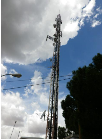
Figura 38. Foto emplazamiento N08.
