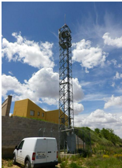
Figura 39. Foto emplazamiento N09.
