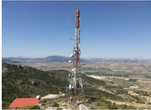
Figura 35. Foto emplazamiento N05.
