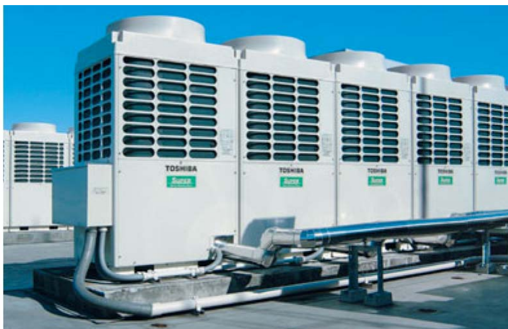
Figura 3.23: Unidades exteriores de equipos de caudal variable de refrigerante
