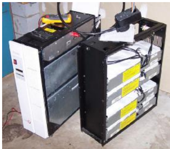
Figura 13. UPS junto a su grupo de baterías
