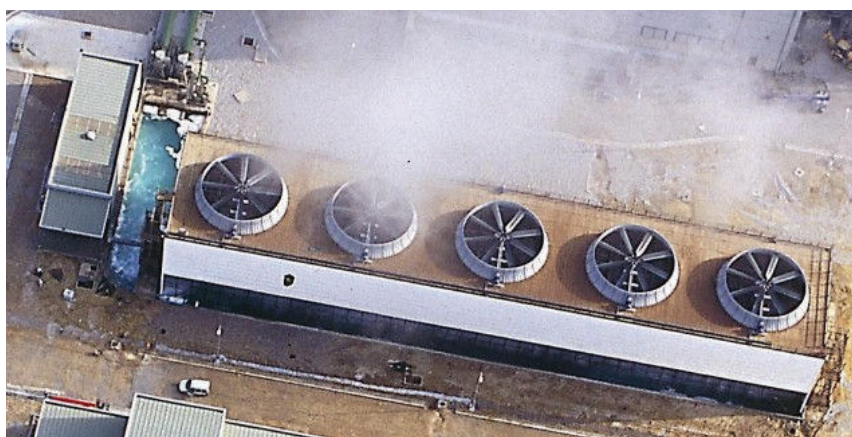
Torres de refrigeración de tiro inducido
