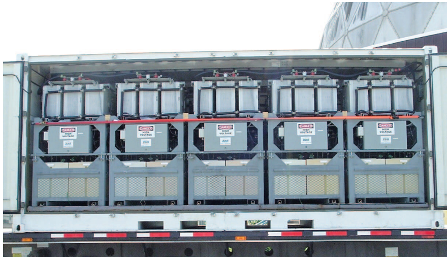
Figura 2.16. Baterías de flujo de Zinc-Bromo 1(500 kW, durante 2 horas).
