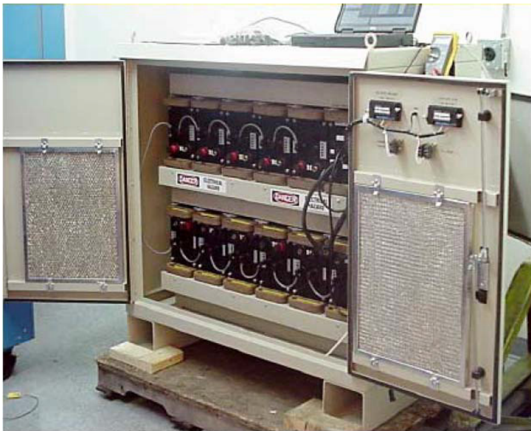
Figura 2.14. Sistema de almacenamiento Li-Ion de 100kW.
