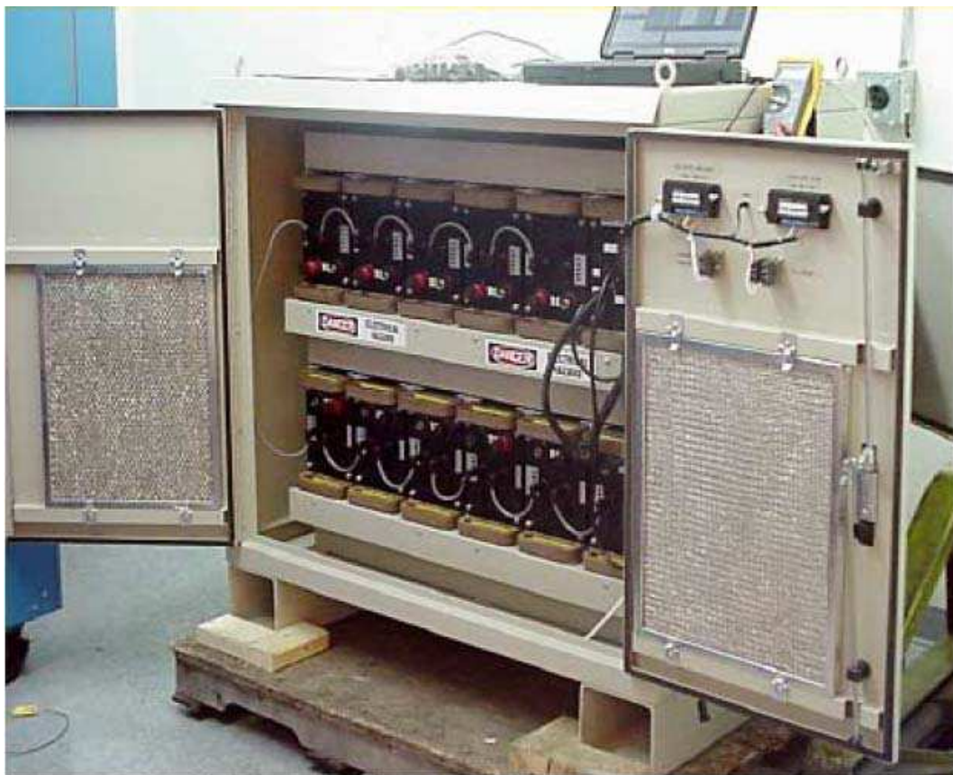
Figura 2.14. Sistema de almacenamiento Li-Ion de 100kW.
