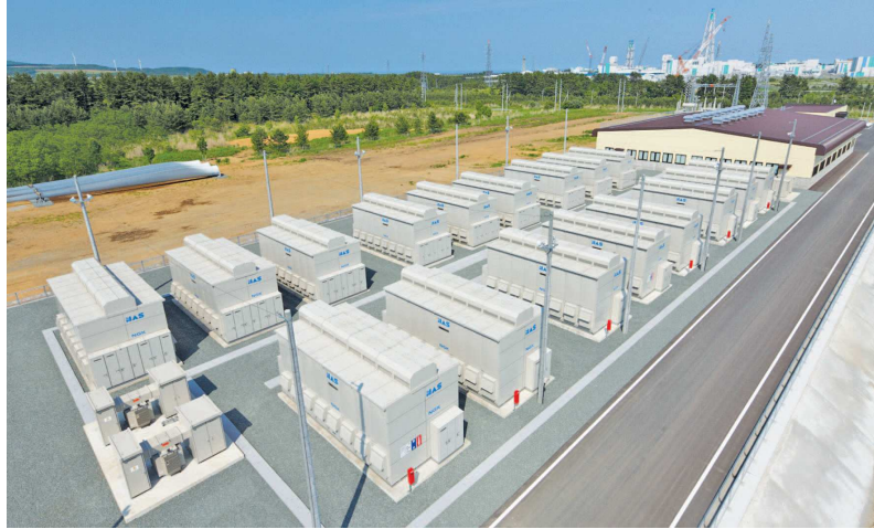
Figura 2.13. 34 MW Junto a Parque Eólico de 51 MW, Japón.
