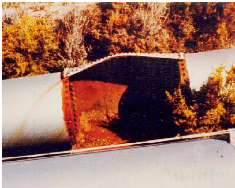
Figura 17.- Imagen de la tubería forzada de una central hidráulica reventada por el golpe de ariete.
