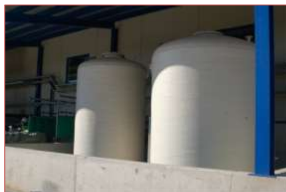
Ilustración 4-6 Tanques de almacenamiento
