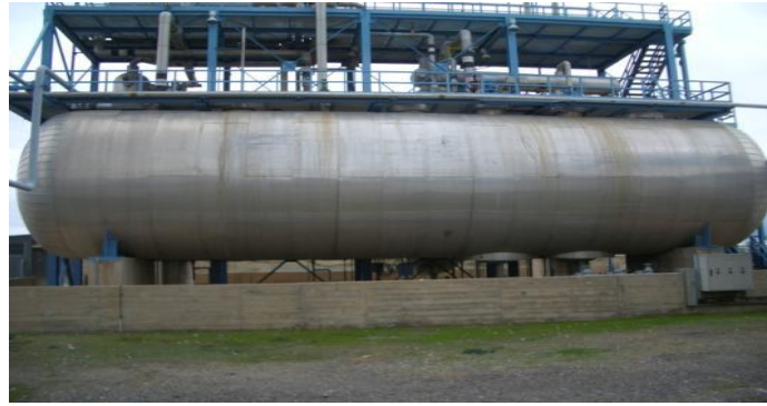
Fig. 1.8: Tanque de almacenamiento de sales.
