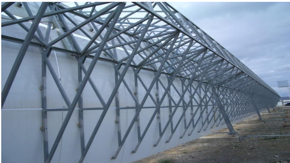
Fig. 2.7: Vista de la estructura del captador EUROTROUGH en posición de abatimiento.
