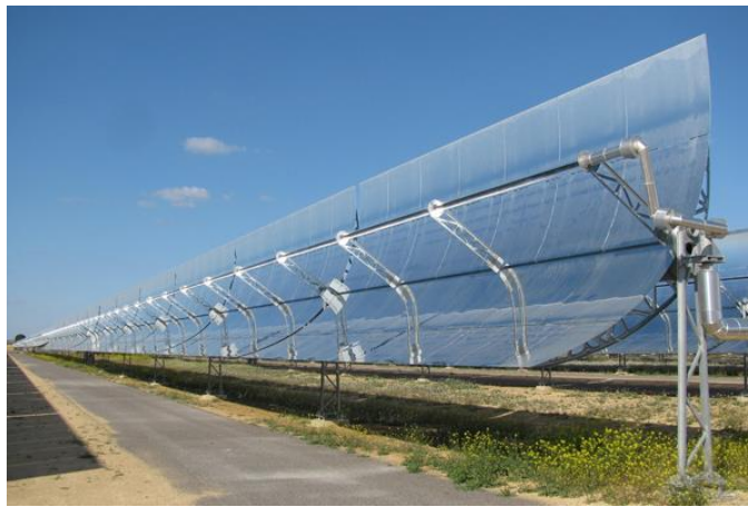
Figura 3. Colector cilindro-parabólico. Fuente: Torresol Energy.
