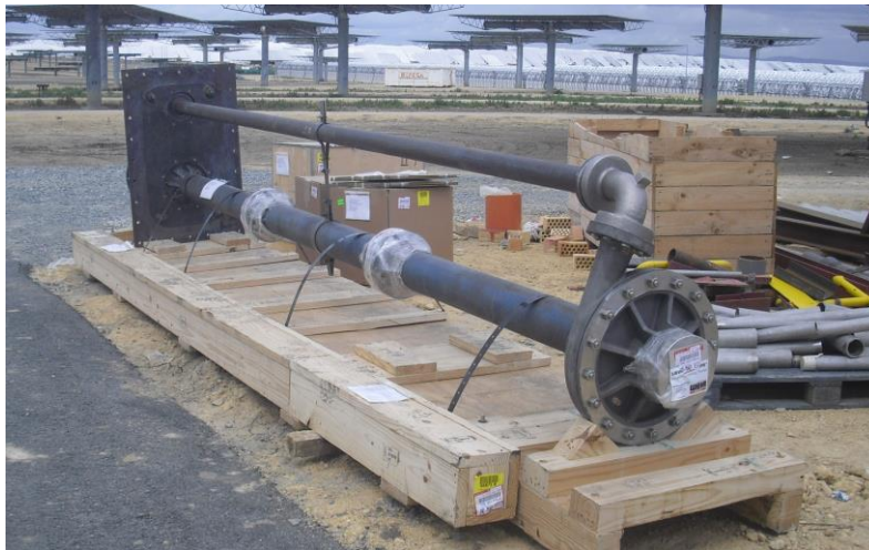
Figura 24. Detalle de estructura de bomba de sales fundidas.
