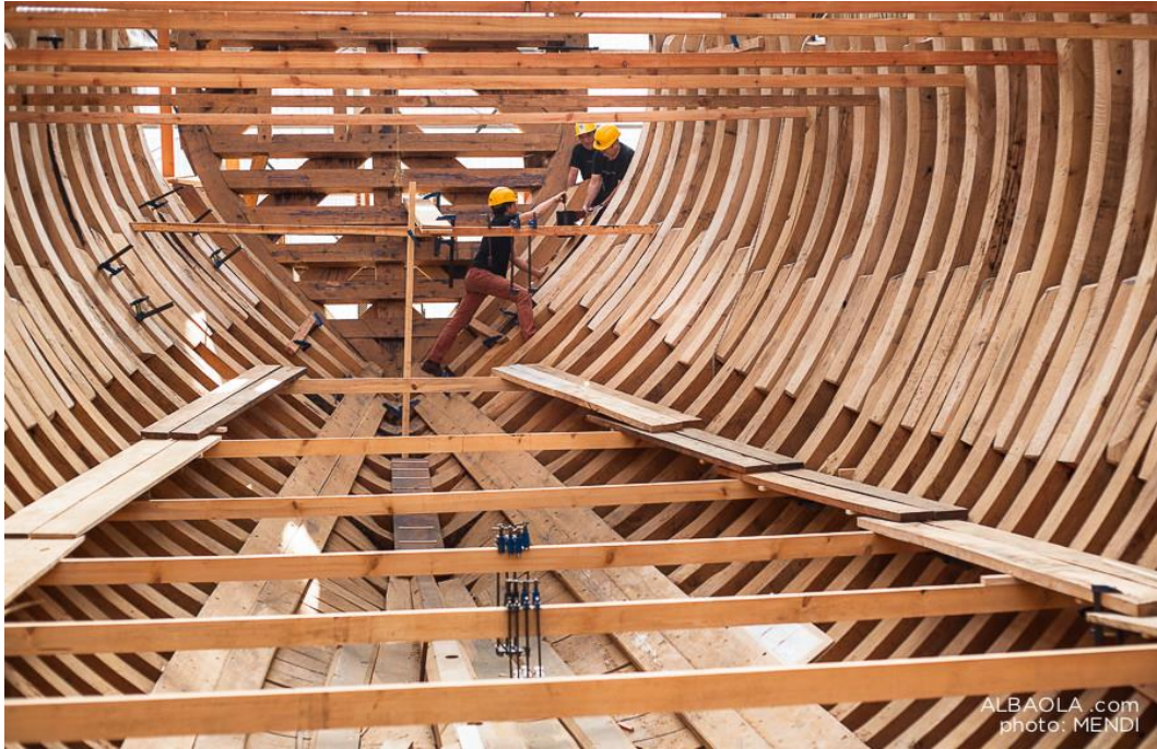
Figura 19: construcción de la nao ballenera San Juan en la factoría marítima Albaola
