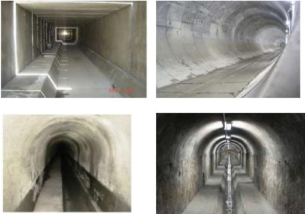
Figura 3-2. Evacuación de las aguas a través de tubos de sección transitable.
