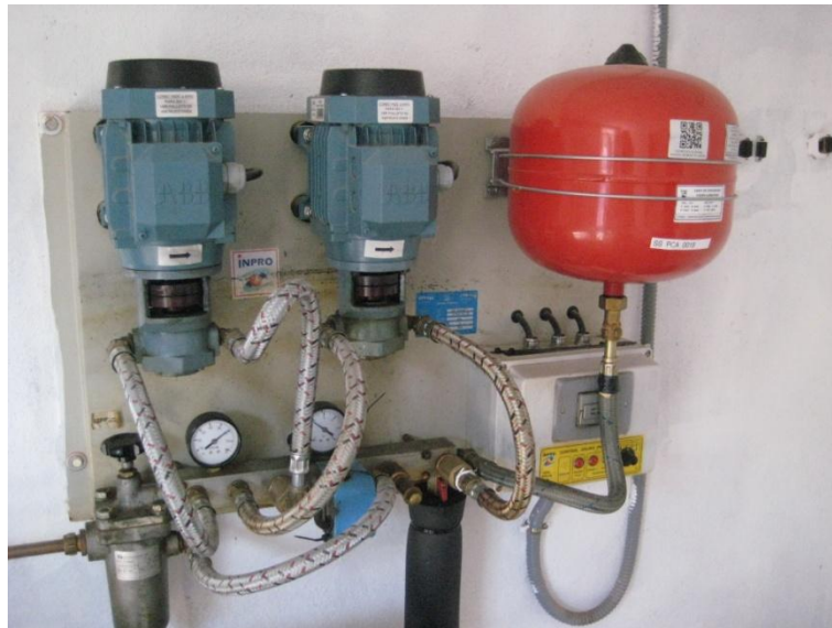
Figura 20 Grupo de bombeo de gasóleo marca INPRO
