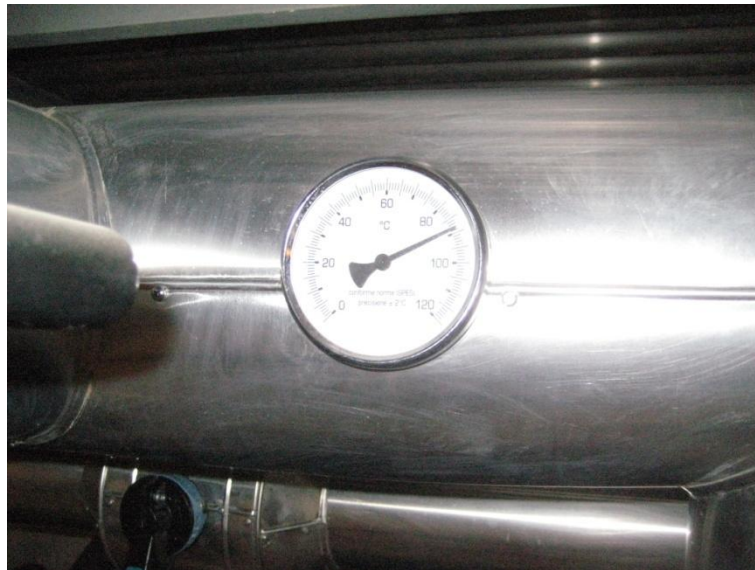
Figura 31 Temperatura del colector común (88°C)
