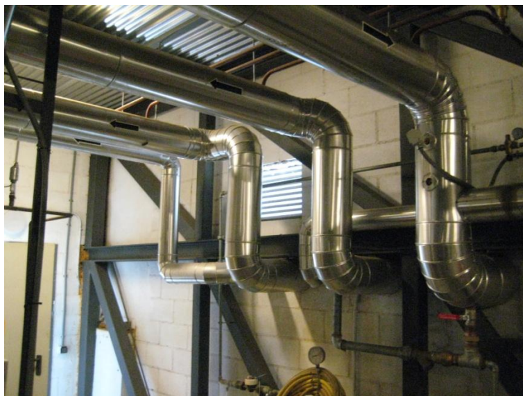
Figura 30 Circuito de impulsión y 3 circuitos de primario de calderas
