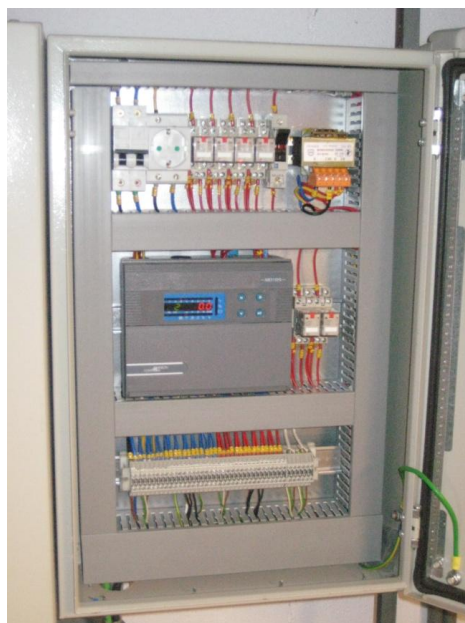
Figura 26 Cuadro de control de la sala de bombas
