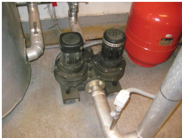
Figura 14 Bombas retorno de A.C.S.
