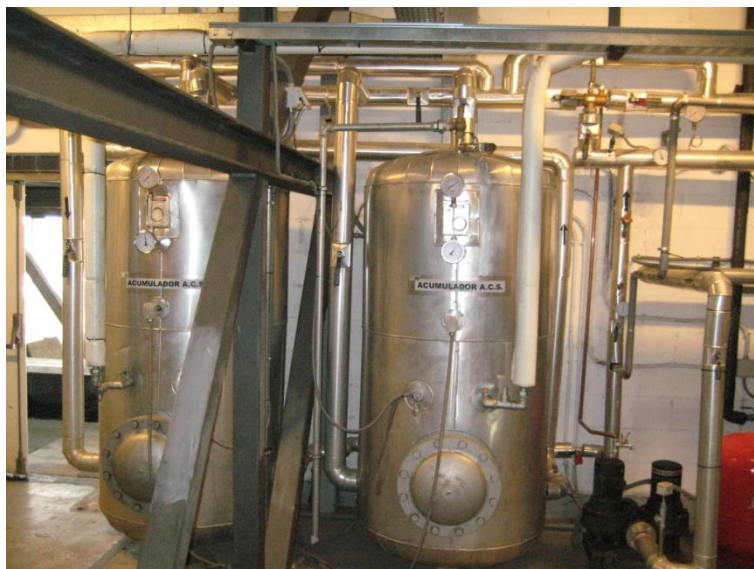
Figura 16 Depósitos de acumulación de A.C.S.
