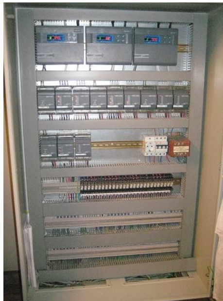
Figura 25 Cuadro de control de la sala de calderas
