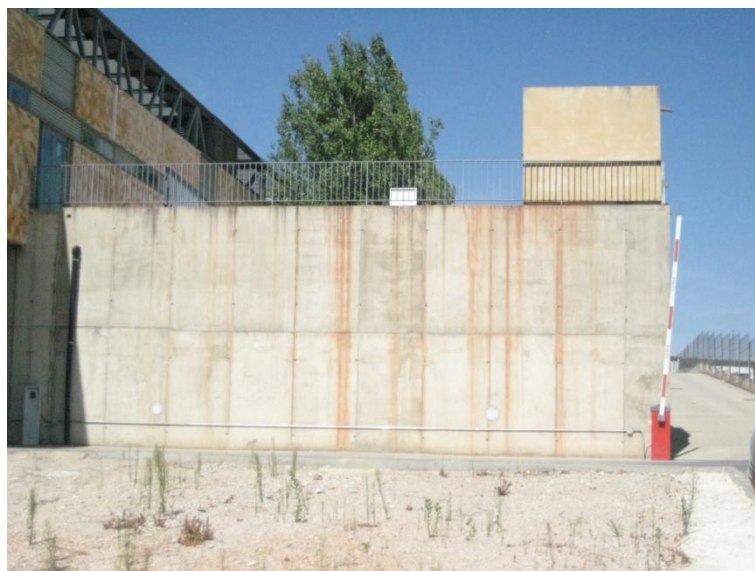
Figura 19 Estructura de contención de los depósitos de gasóleo
