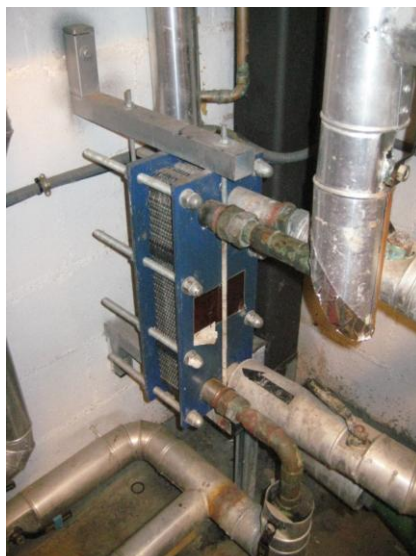
Figura 15 Intercambiadores de placas circuito de producción de A.C.S.
