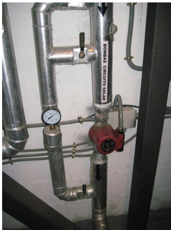
Figura 18 Bombas circuito A.C.S. Solar
