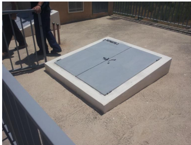
Figura 10: Compuertas de acceso a depósitos de gasóleo enterrados
