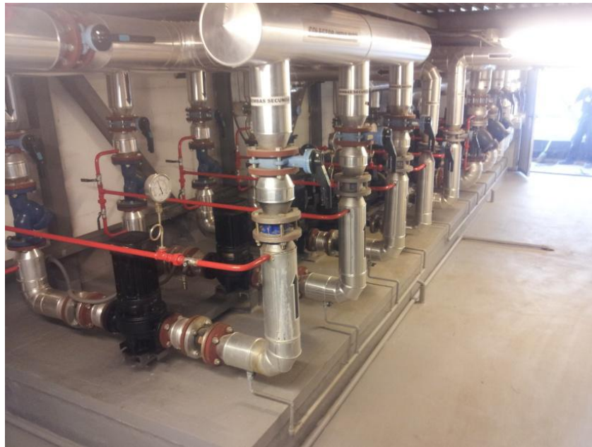
Figura 7: Actual sala de bombeo y distribución de calor
