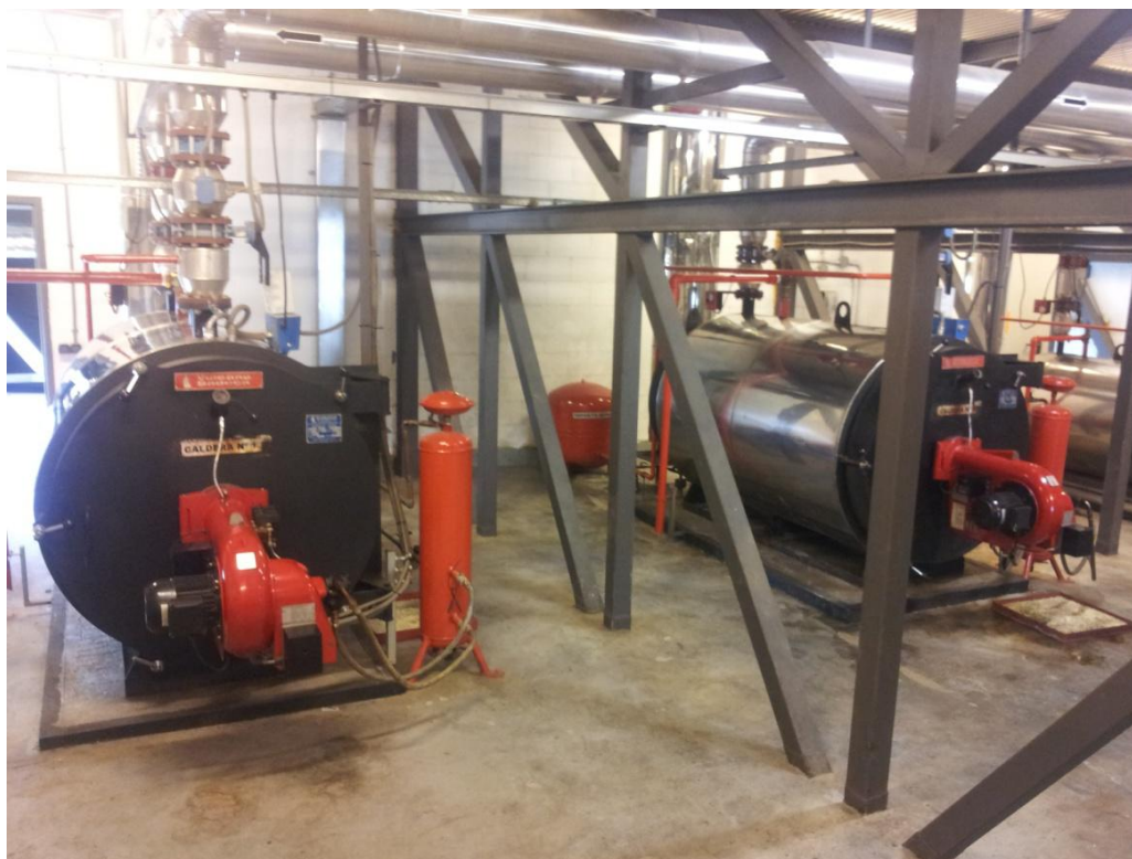
Figura 6: Actuales calderas de gasóleo para producción térmica
