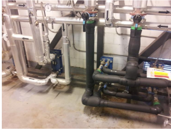
Figura 9: Intercambiadores de A.C.S.
