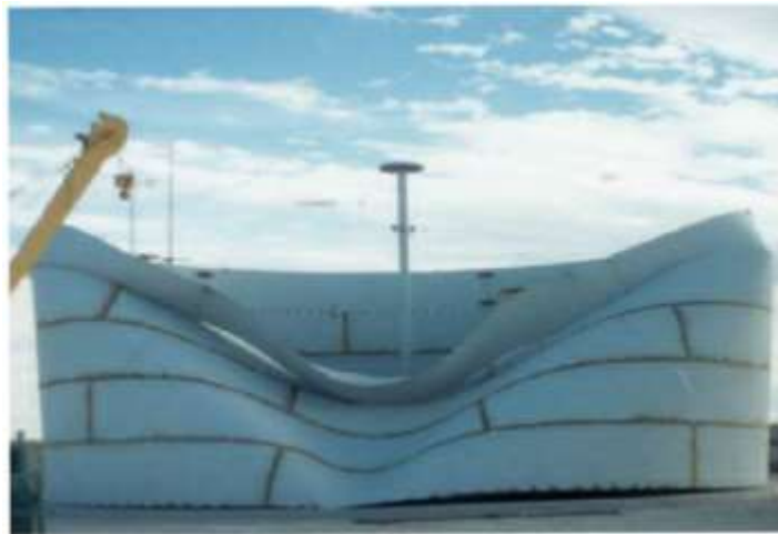
Figura 7-1. Fallo de la virola durante el montaje.
