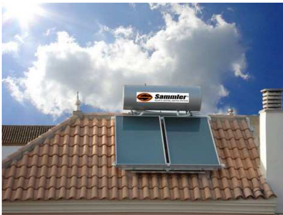
Figura 2.3 Sistema compacto por termosifón
