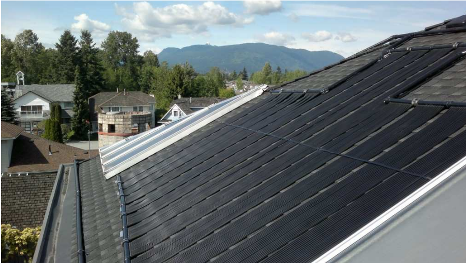
Figura 1.11 Captadores planos sin cubierta. Obsérvese cómo el absorbedor está directamente montado sobre el tejado sin ningún tipo de carcasa o aislamiento.
