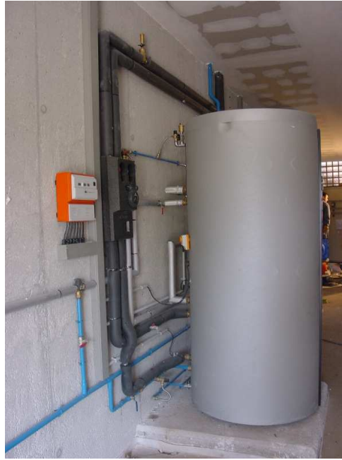
Figura 1.23 Acumulador de inercia para calefacción por suelo radiante. (“Icarus Solar. Energías renovables,”)
