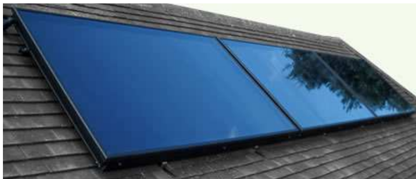
Figura 1.10 Captadores planos para ACS en una vivienda
