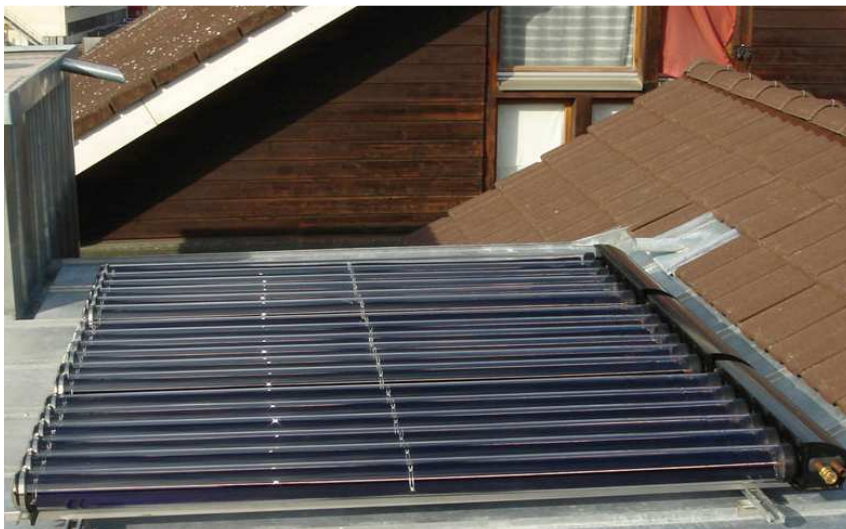
Figura 1.19 Tubos de vacío de flujo directo sobre una cubierta horizontal.
