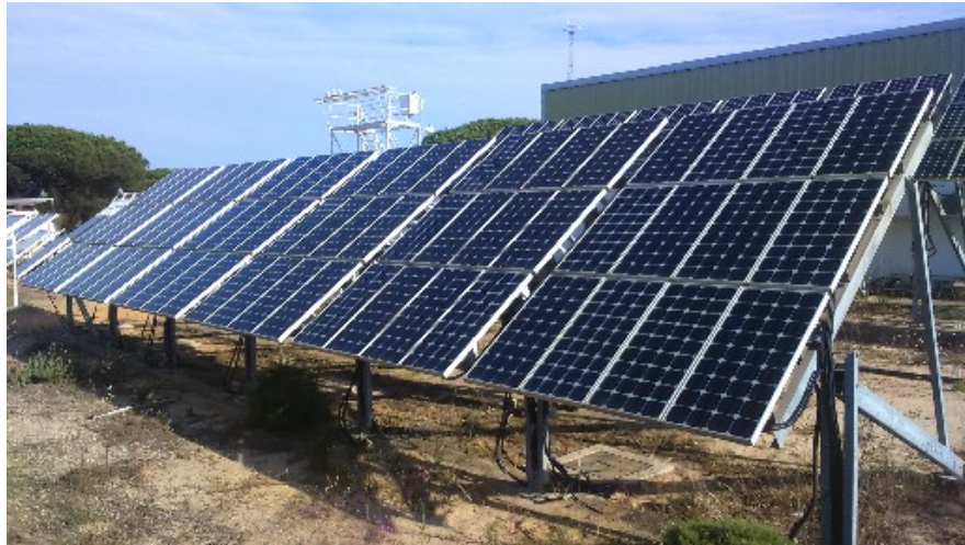
Figura 2-15. Campo fotovoltaico en El Arenosillo, Moguer (Huelva), fuente INTA.
