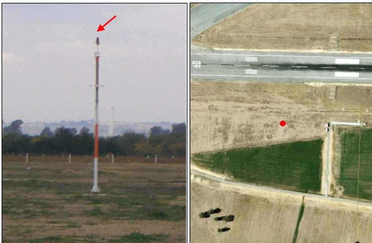
Imagen y situación de la antena de la antena monitora de la senda de planeo 09
