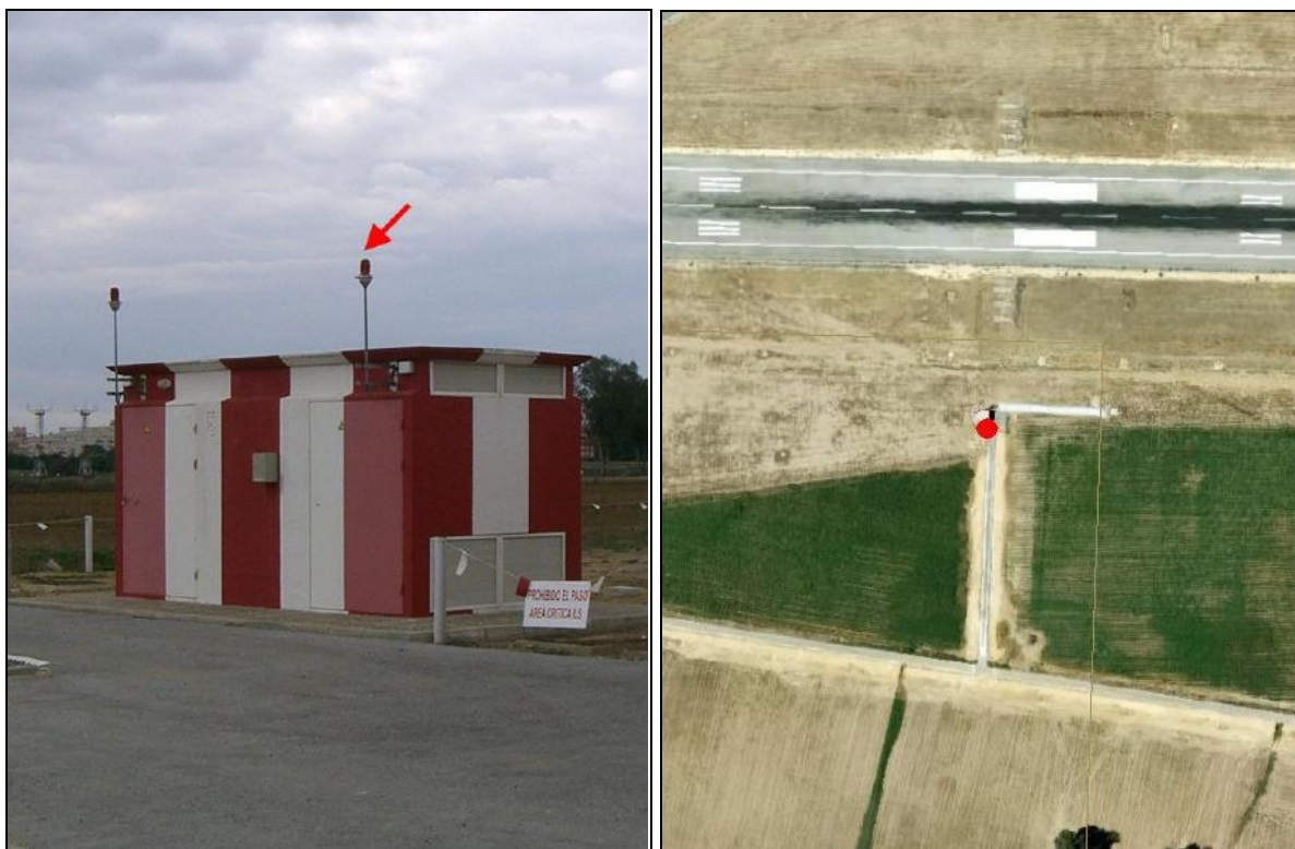
Imagen y situación de centro de transformación de senda de planeo 09
