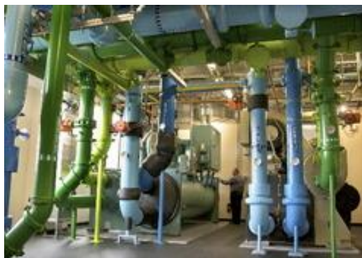
Imagen 11.- Enfriadoras de agua en sala de máquinas (Beaverton, Oregon) 25 .
