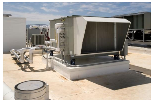
Imagen 10.- Bomba de calor de tipo Roof-Top 24 .
