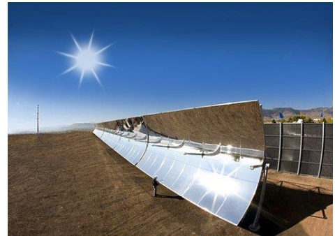
Imagen 28.- Colector solar cilíndrico-parabólico 47 .
