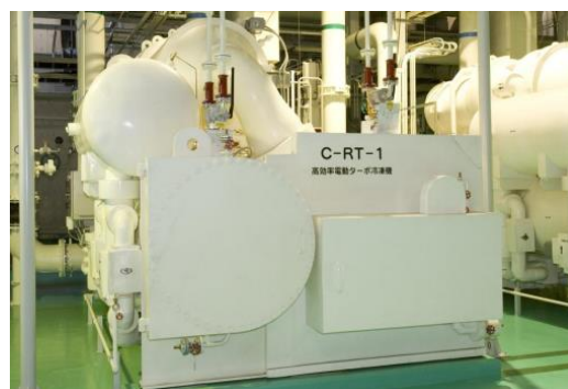
Imagen 8.- Enfriadora centrífuga de 7000 kW de potencia térmica en el Aeropuerto de Kansai (Japón) 22 .
