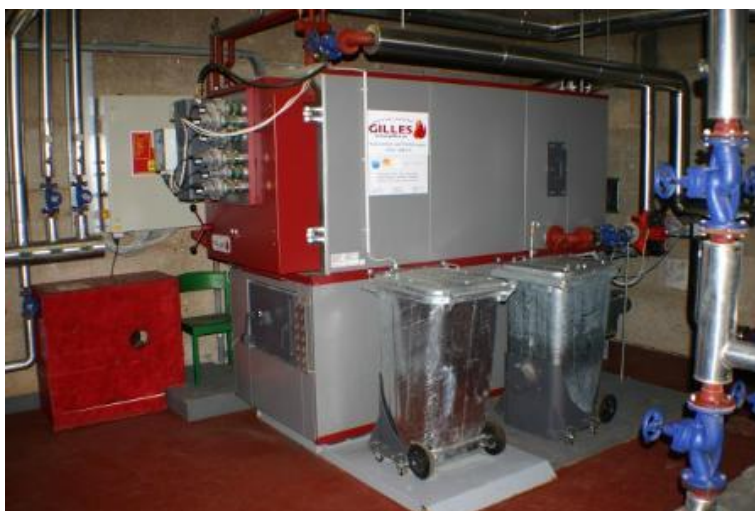
Imagen 5.- Caldera de biomasa para astillas de madera en el Aeropuerto de Stansted, (Londres, UK) 11 .
