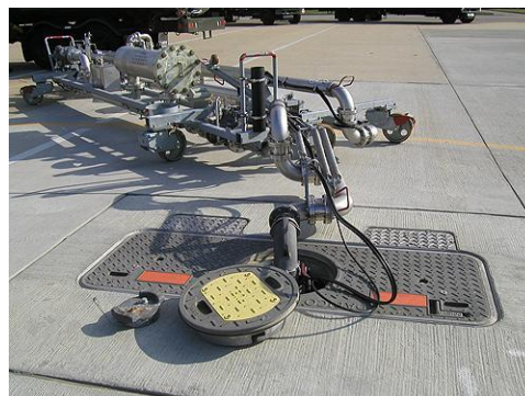
Imagen 38.- Conexión a sistema de abastecimiento de combustible subterráneo con hidrante de combustible 56 .
