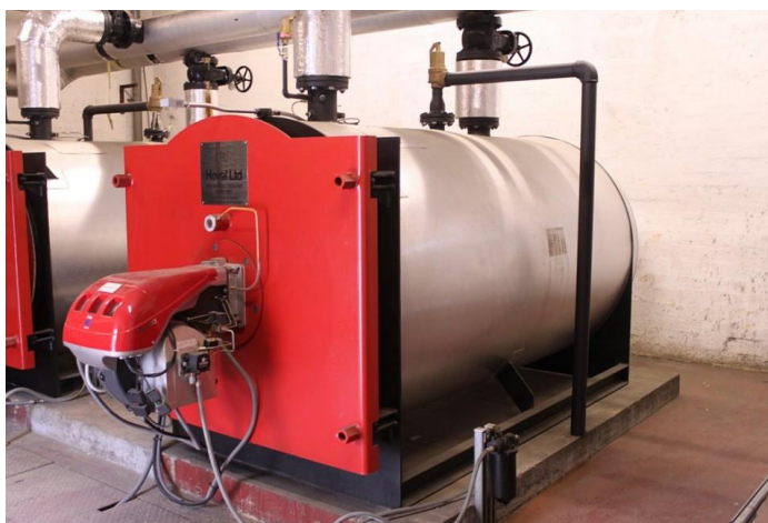
Imagen 4.- Caldera de gas en la sala de calderas del Aeropuerto de Sumburgh, (Islas Shetland, Escocia) 10 .
