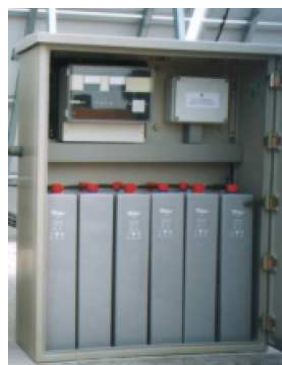
Figura. Baterías de gel. También son estacionarias. El electrodo está gelificado, de modo que no precisan mantenimiento y pueden funcionar colocadas en cualquier posición.
