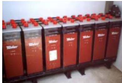
Figura. Baterías estacionarias. Gran capacidad de funcionamiento en regímenes de carga y descarga lentas.
