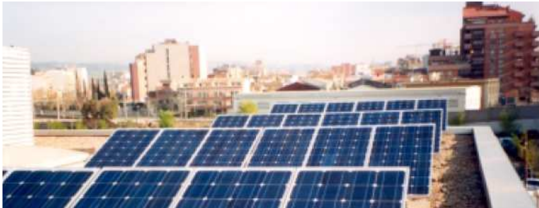
Figura. Paneles fotovoltaicos de silicio monocristalino en cubierta.
