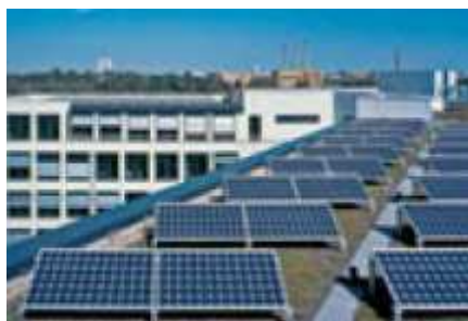
Figura. Módulos fotovoltaicos en edificación.
