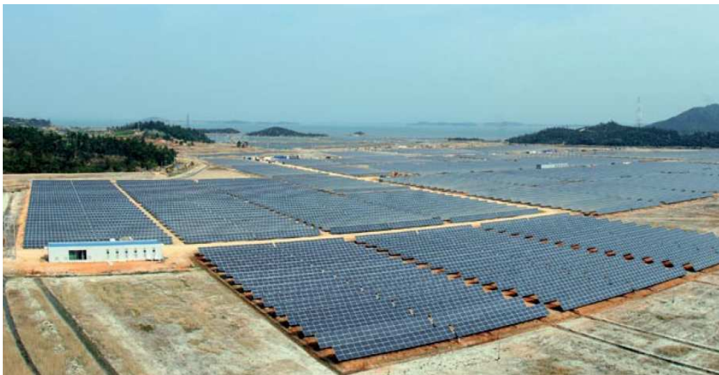
Figura. Mayor planta fotovoltaica construida en Asia. Corea del Sur, 2008.
