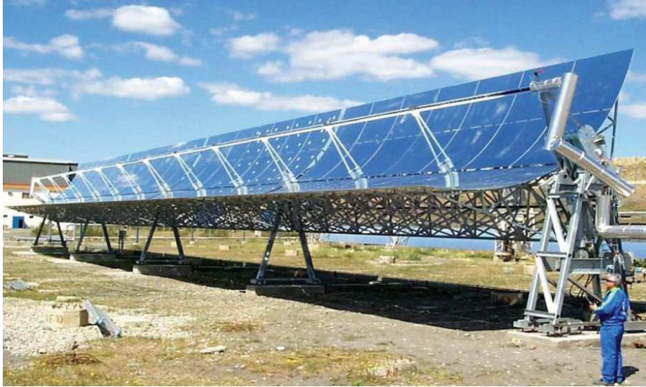
Figura. Colector solar cilíndrico-parabólico.
