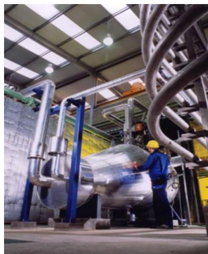
Fig. 31. Vista parcial de la instalación del proceso AquaCat.
