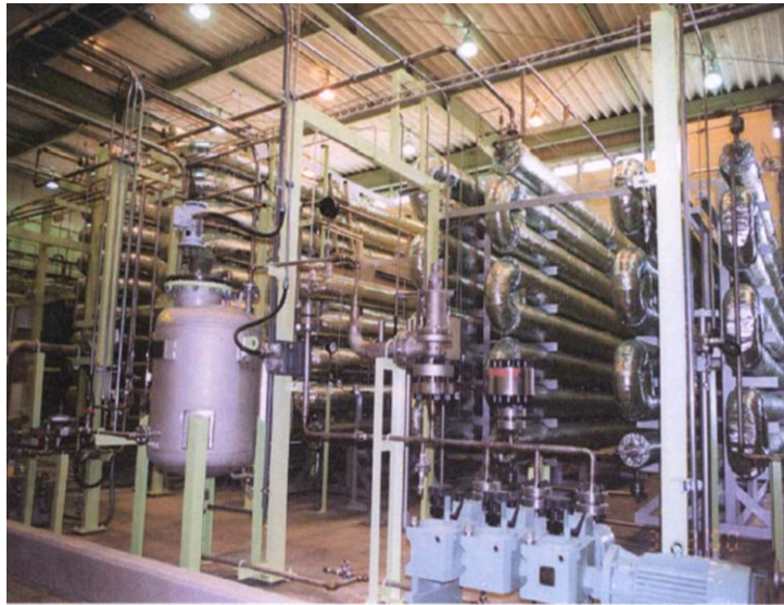
Fig. 30. Vista de la planta de Shinko Pantec.
