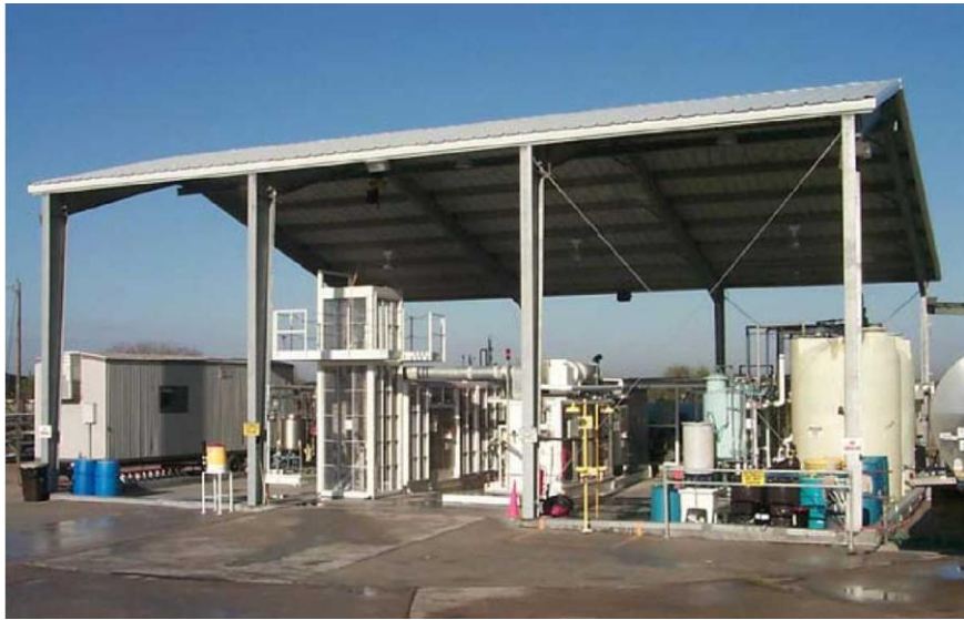
Fig. 13. Vista general de la planta de OASC en Newport - Indiana, GA.
