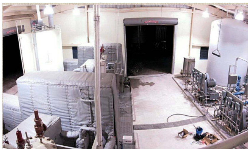
Fig. 28. Vista interior de la planta Hydrosolids®.
