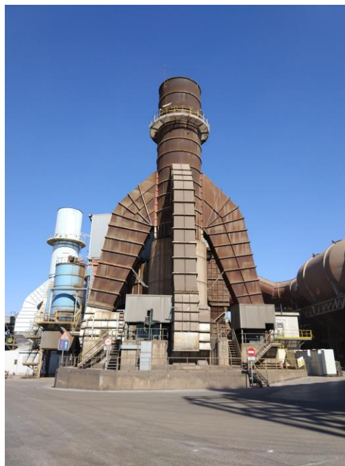
Figura 3-4. Filtro y ventiladores principales
