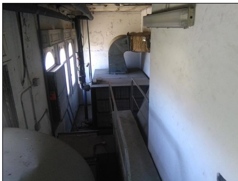
Figura 13. Sala de máquinas con climatizadora existente
