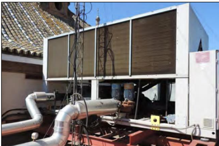
Figura 12. Bombas de calor existentes en cubierta transitable
