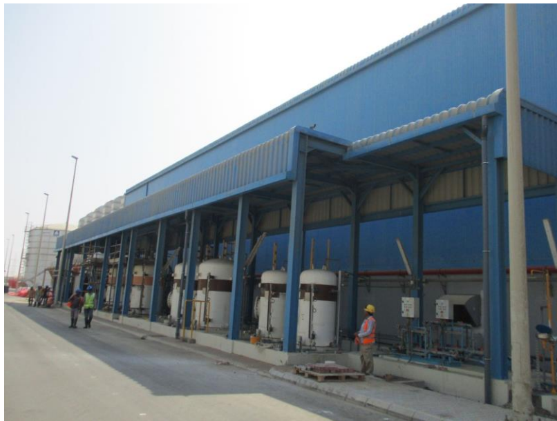
Figura 19: Tanque dosificador de almacenamiento y pretratamiento de productos químicos.
