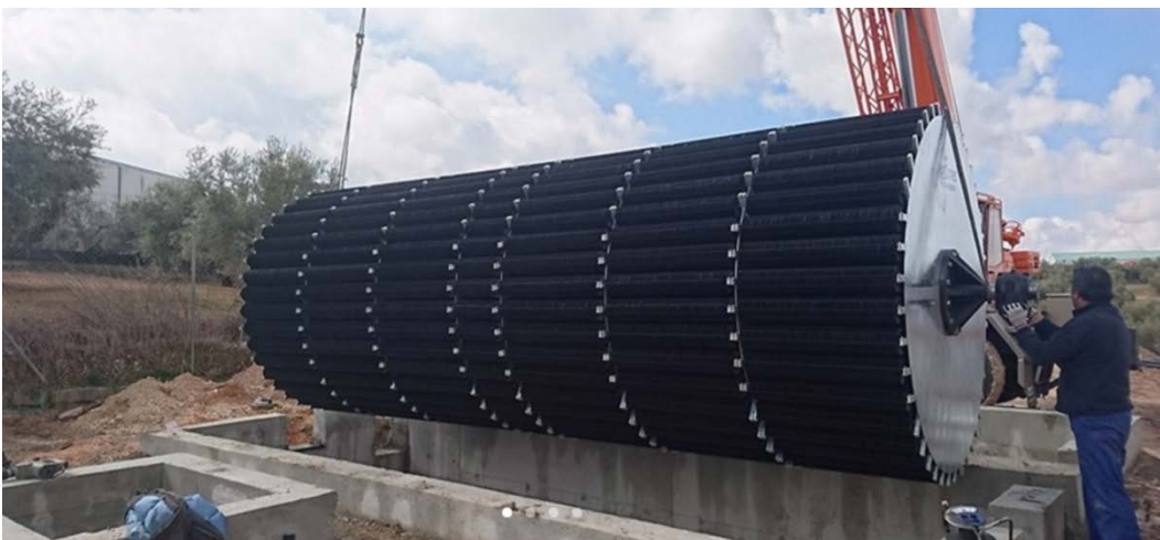
Figura 5-12. Instalación de un Biodisco en Campo. Fuente: https://www.aguasresiduales.info/expertos/tribuna-opinion/biodiscos-la-solucion-perfecta-en-el-tratamiento-de-aguas-residuales-en-pequenas-pobl-amVHc .
