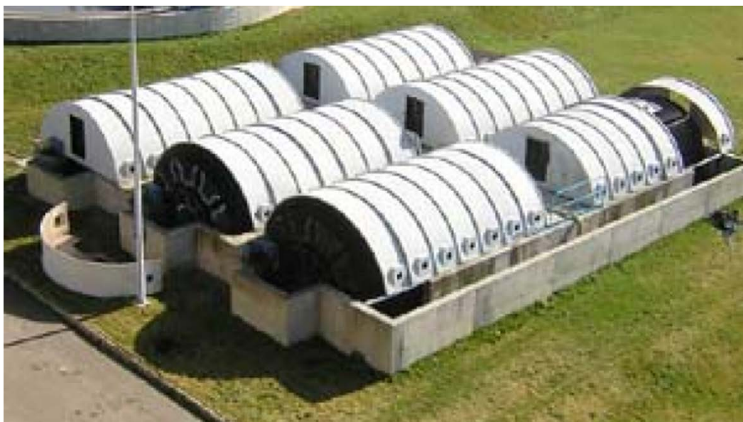
Figura 5-14. Biodiscos Instalados en Campo de Varias Etapas. Fuente: https://www.iagua.es/blogs/jorge-chamorro/depuracion-principiantes-xi-imhoff-biodiscos-ejemplo .
