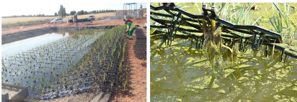
Figura 7-8. Sistema de soporte para el crecimiento de las plantas helófitas en humedales construidos
