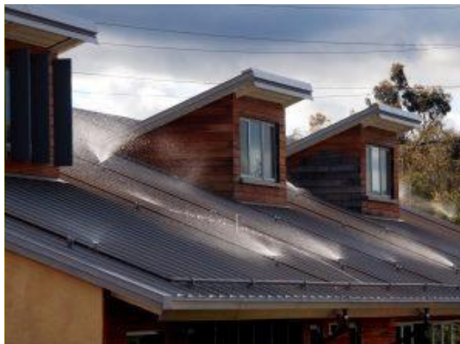
Figura 5. Sistema de enfriamiento evaporativo – radiante.
