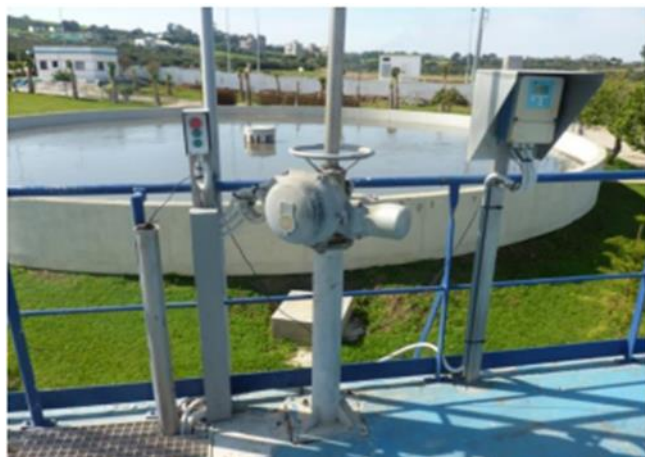
Foto 14: ph - metro en la salida de la trampa de arena
