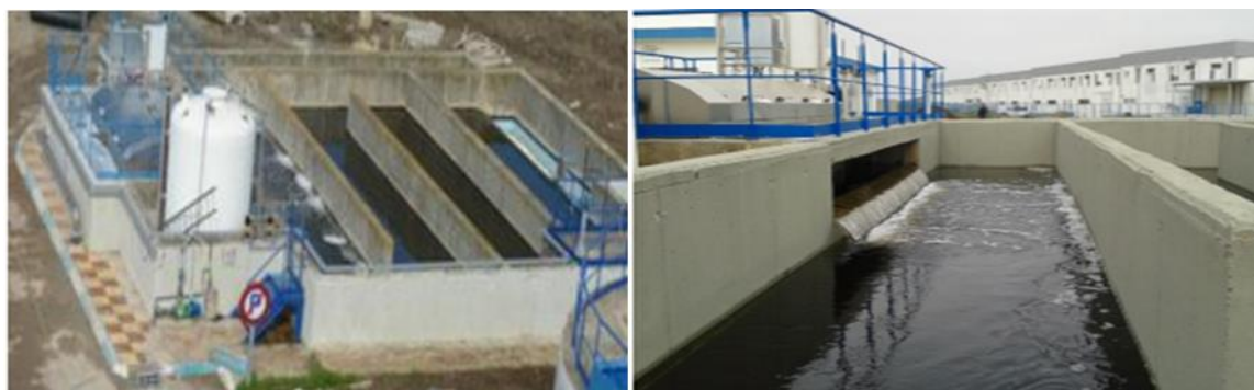
Foto 20: el área de tratamiento terciario
