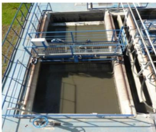
Foto 10: puente raspador para eliminación de arena / aceite en desagüe
