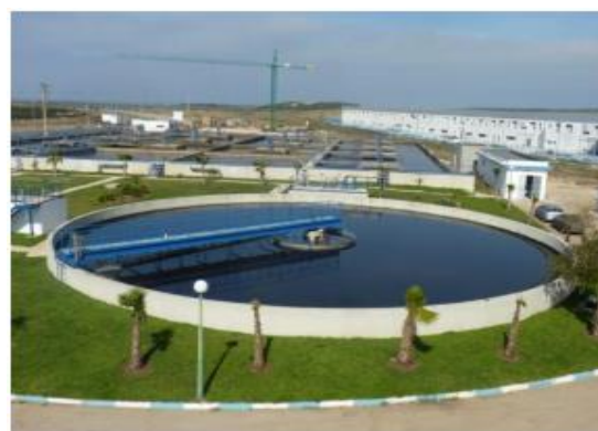
Foto 18: tanque de sedimentación secundario de sedimentación secundario raspado
