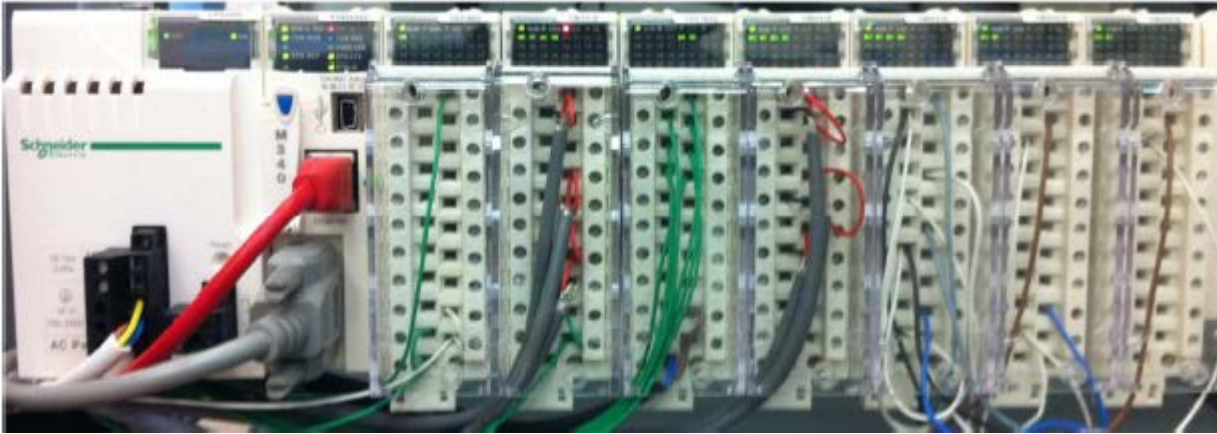
Figura 13. PLC M340 instalado en la microrred. [20]
