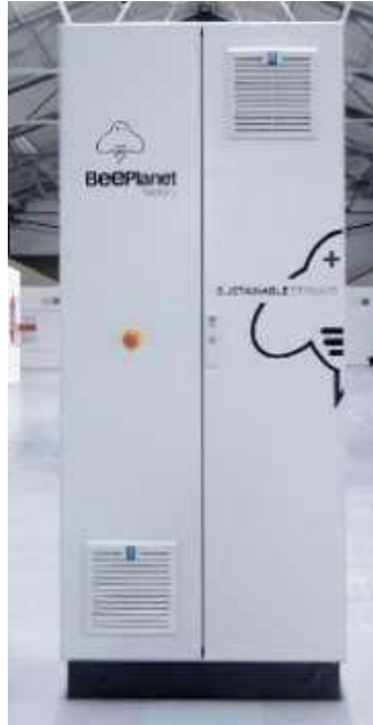
Ilustración 50 Armario con baterías de almacenamiento (Beeplanet Factory, s/f).
