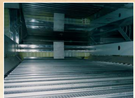
Cámara para secar y enfriar
