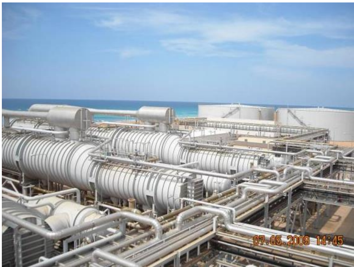
Figura 5.4. Planta desalinizadora de Abutaraba
