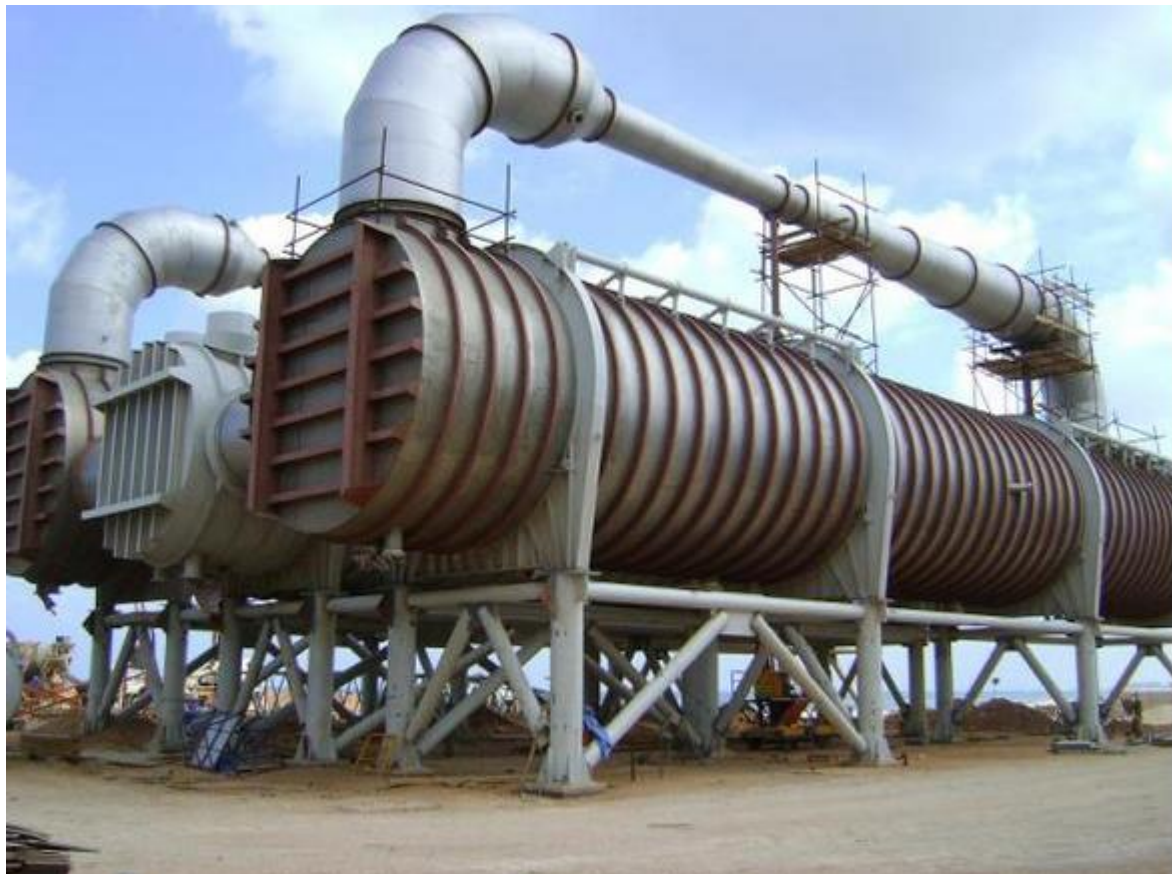
Figura 5.3. Planta desalinizadora de Za2ia Derna Sussa.
