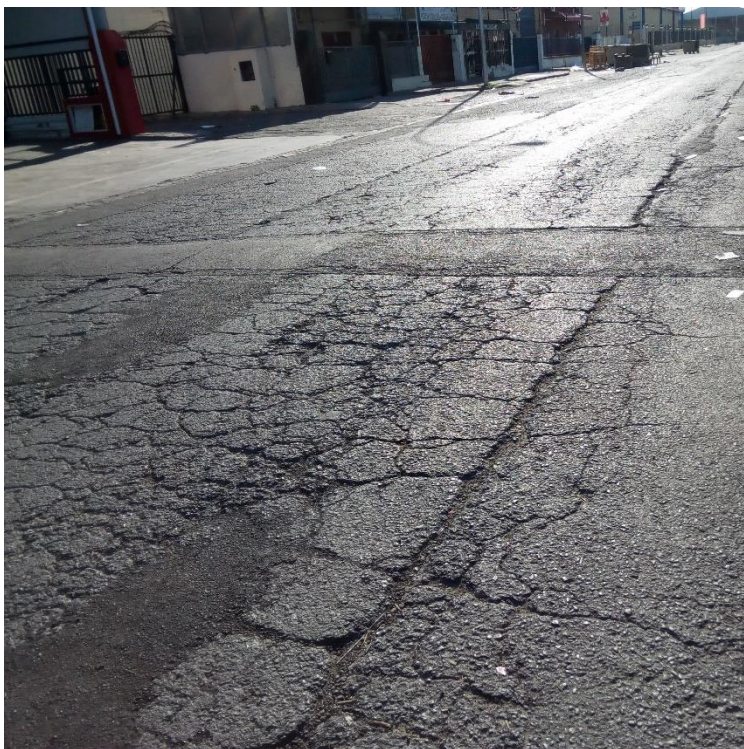
Figura 23. Calle José María Ibarra Gómez-Rull, con firme en mal estado.
