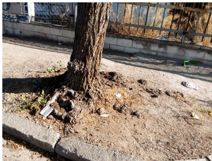
Figura 29. Acera en mal estado en la Avenida la Industria.
