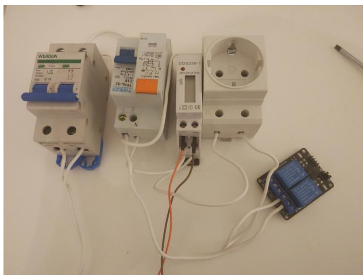
Ilustración 4-18 Conexión completa del cuadro eléctrico
