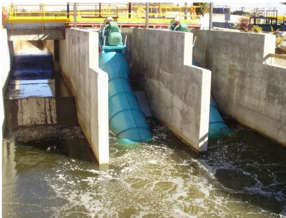
Figura 13. Turbinas en el desagüe de la EDAR Sur de Madrid, producen 1500 MWh al año. Fuente: (Madrid Subterra, 2017).
