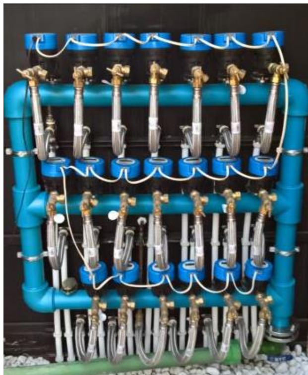
Figura 2-2. Batería de contadores divisionarios
