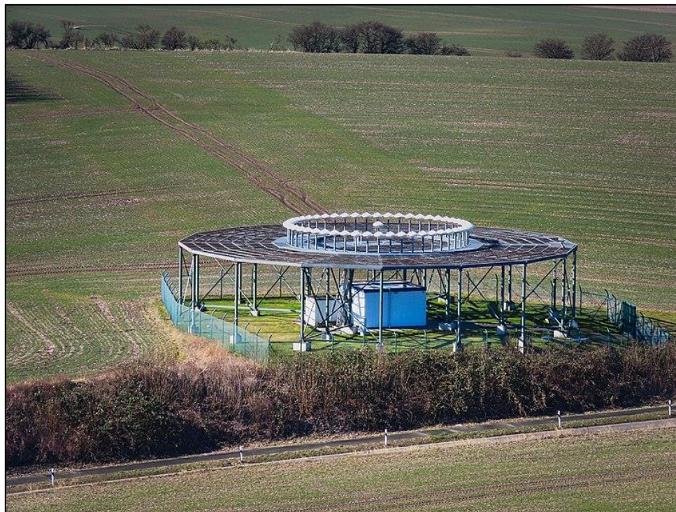
Figura 2-5. Imagen de una estación VOR en tierra [39].
