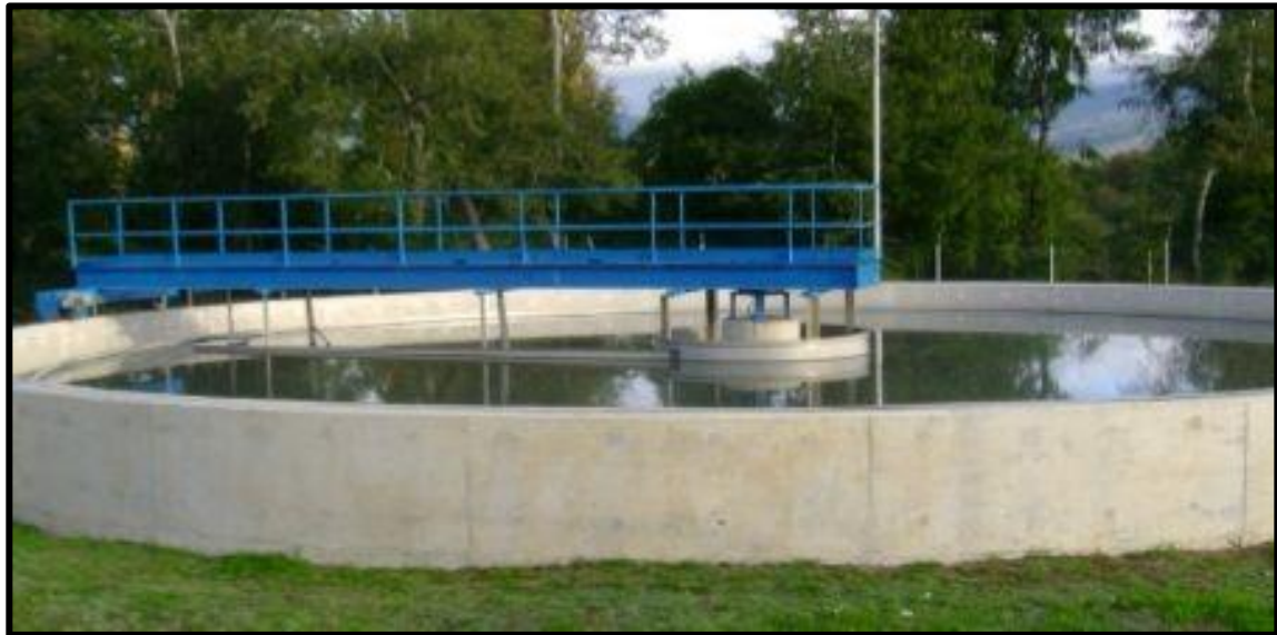
Figura 13. Puente del decantador.
