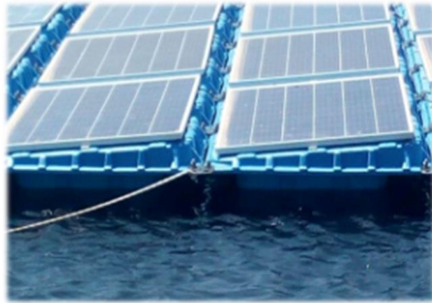
Figura 2: Detalle del flotador con la placa solar en inclinación de 5°. [B]
