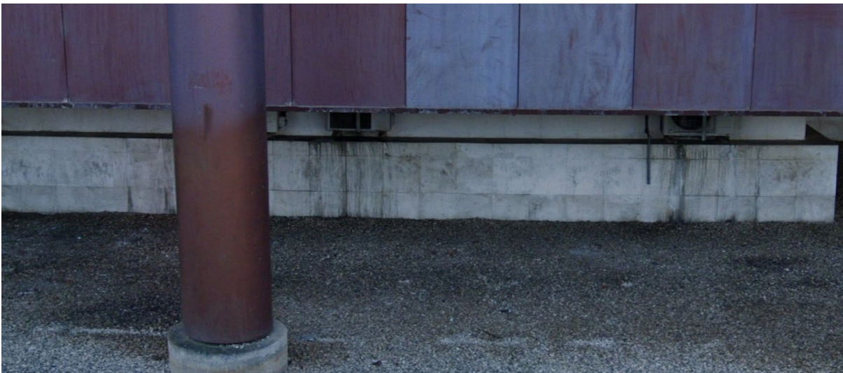
Figura: 16. Máquinas de aire en la piscina
