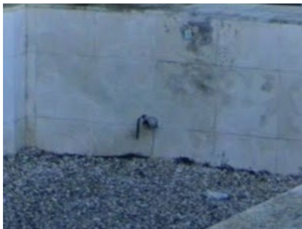
Figura: 24. Toma de agua en una piscina
