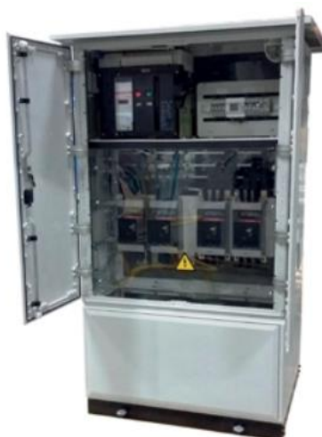
Figura 39. Cuadro general de baja tensión
