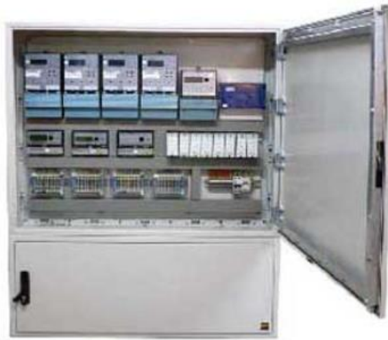
Figura 7. Armario de medida de subestación
