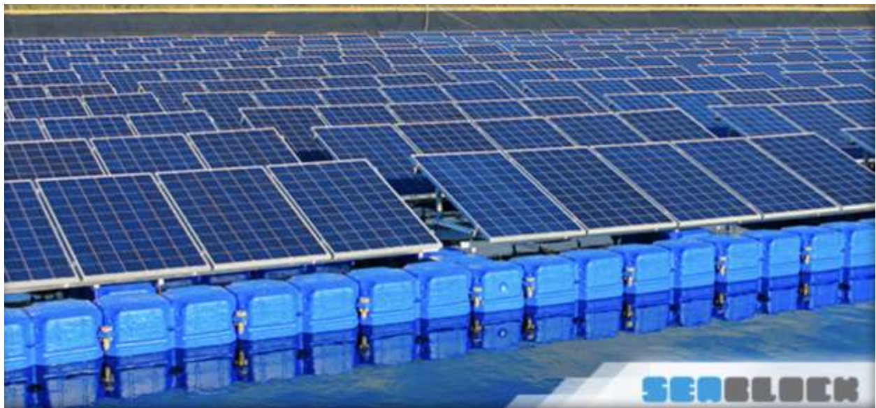
Figura 6. Instalación fotovoltaica flotante de Sea Block
