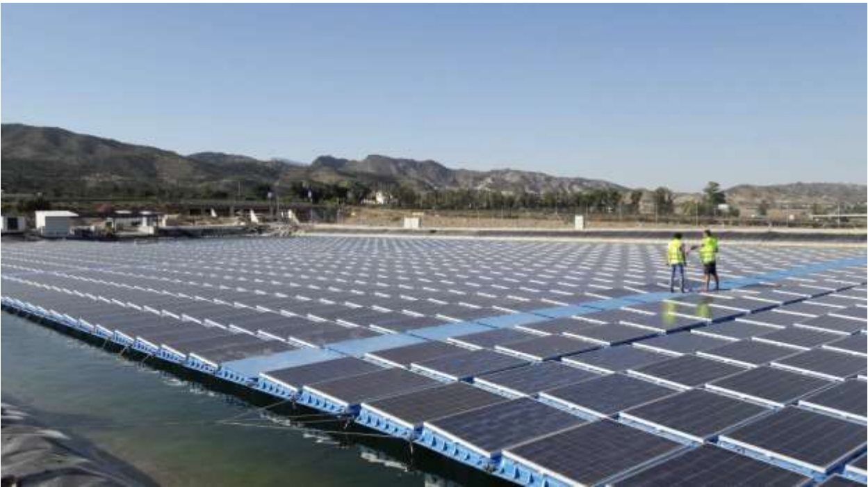
Figura 7. Instalación fotovoltaica flotante de Isigenere
