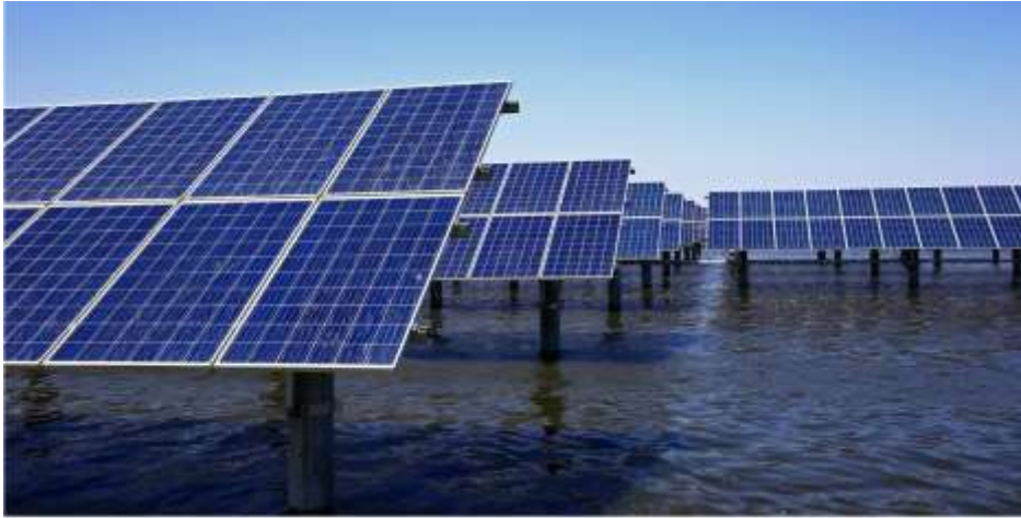
Figura 3. Ejemplo de instalación fotovoltaica flotante fija
