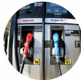
Figura 2: Medidor de flujo en un surtidor
