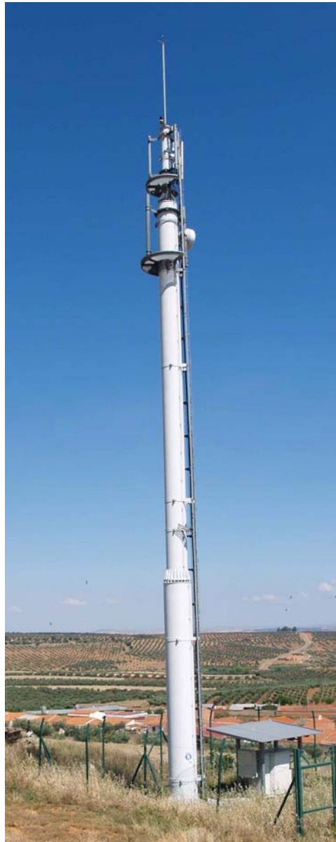
Ilustración 4: ejemplo de torre monopolo
