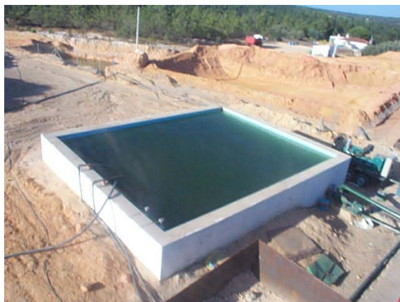
Depósito y balsas de decantación.
