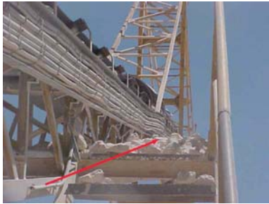
Fotografía nº 35 – CINTA/TC-17. Riesgo de tropiezo por material de producción.
