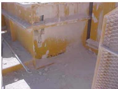
Fotografía nº 15 – MACHACADORA/MM-08. Resguardo insuficiente.
