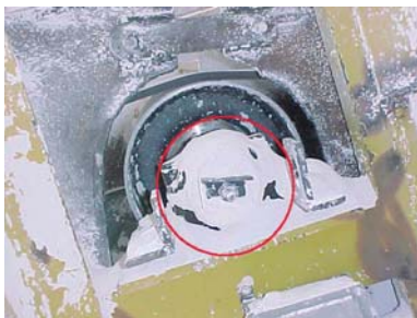
Fotografía nº 3 – CINTA/TC-511. Resguardo insuficiente.
