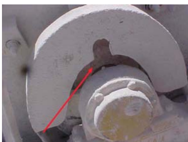
Fotografía nº 31 – CRIBA/CV-104. Resguardo insuficiente.
