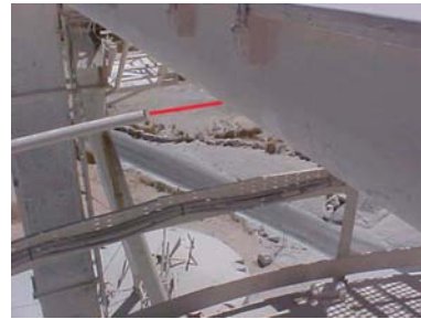
Fotografía nº 66 – ELEVADOR/EC-2201. Falta parte de barandilla.
