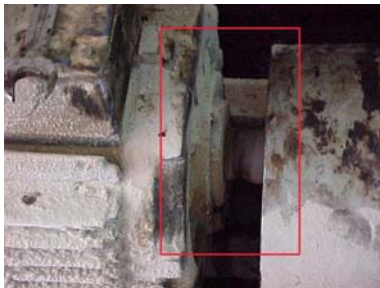
Fotografía nº 5 – BOMBA/BG-01. Resguardo insuficiente.
