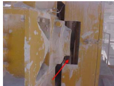
Fotografía nº 28 – MOLINO/MR-14. Resguardo de protección insuficiente.
