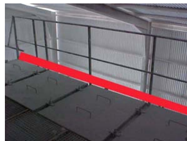
Fotografía nº 16 – HIDRATADORES/H-1/H-2. Faltan rodapiés.
