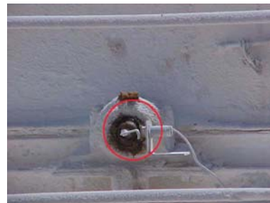
Fotografía nº 70 – ELEVADOR/EC-2201. Falta resguardo de protección.
