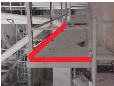
Fotografía nº 31 – SEPARADOR/SE-2015. Faltan rodapiés.
