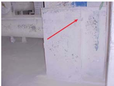
Fotografía nº 69 – ELEVADOR/EC-2201. Falta sistema de enclavamiento en el resguardo.
