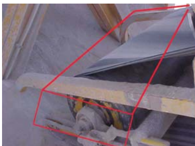
Fotografía nº 31 – CINTA/TC-15. Falta resguardo de protección.
