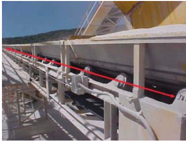
Fotografía nº 19 – CINTA/TC-10. Falta resguardo de protección.
