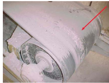
Fotografía nº 12 – CINTA/TC-560. Falta resguardo de protección.
