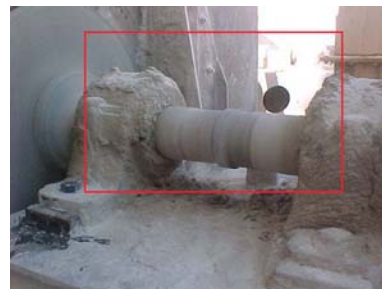
Fotografía nº 8 – VENTILADOR/VFM-H4. Falta resguardo de protección.
