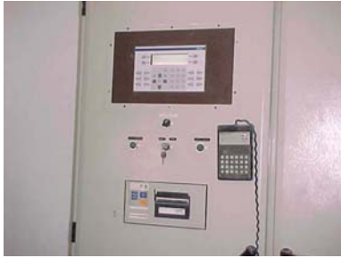
Fotografía nº 1 _ CUADRO DE MANDO. Falta parada de emergencia general de la línea.
