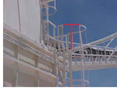
Fotografía nº 34 – TOLVA/TR-105. Reparar quitamiedos de la escalera.
