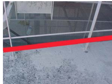
Fotografía nº 6 – VENTILADOR/VFM-H4. Faltan rodapiés.
