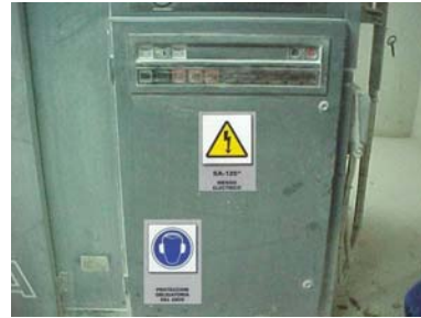
Fotografía nº 12 – COMPRESOR/AC-1210. Señalizar riesgo eléctrico y uso de cascos auditivos.
