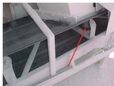
Fotografía nº 32 – CINTA/TC-605. Falta resguardo de protección.
