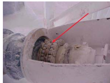
Fotografía nº 46 – SINFÍN/SF-2019. Falta resguardo de protección.
