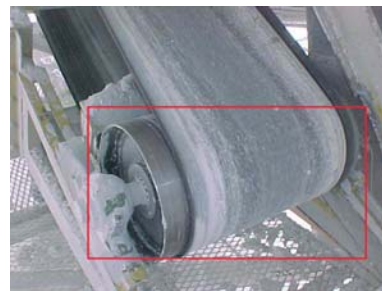
Fotografía nº 4 – CINTA/TC-511. Falta resguardo.
