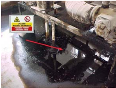
Fotografía nº 1 – BOMBA/BD-01. Instalar sistema de recogida de fueloil y señalizar riesgo.
