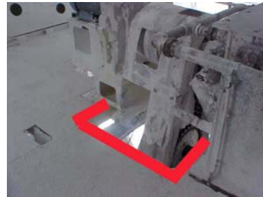
Fotografía nº 14 – HIDRATADORES/H-1/H-2. Faltan rodapiés.
