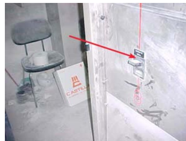
Fotografía nº 4 – CUADRO DE MANDO. No existe seccionador eléctrico encandable.
