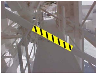
Fotografía nº 73 – SINFÍN/SF-22. Señalizar riesgo de golpeo.
