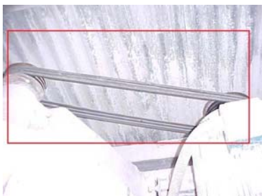
Fotografía nº 63 – VENTILADOR/VF-2353. Falta resguardo de protección.
