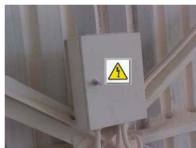
Fotografía nº 24 – TOLVA/TR-109. Señalizar riesgo eléctrico.
