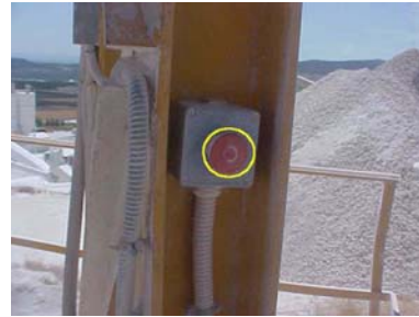
Fotografía nº 36 – MOLINO/MM-20. Falta señalización de parada de emergencia.
