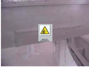
Fotografía nº 89 – SINFÍN/SF-2355. Señalizar riesgo de atrapamiento en compuerta de descarga rápida.
