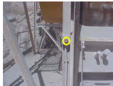
Fotografía nº 14 – CINTA/TC-562. Falta resguardo de protección.
