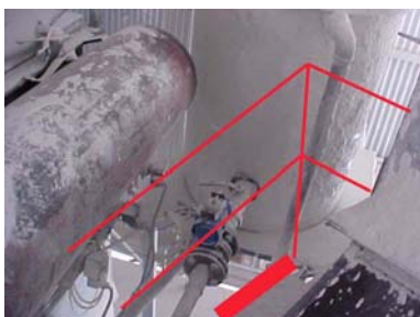
Fotografía nº 7 – CINTA/TC-2002. Faltan elementos de seguridad en accesos.
