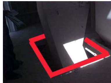
Fotografía nº 20 – CINTA/TC-161. Faltan rodapiés.
