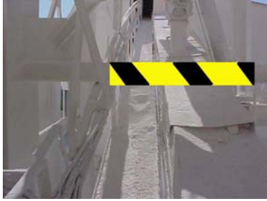
Fotografía nº 9 – CINTA/TC-2002. Señalizar riesgo de golpeo.
