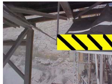
Fotografía nº 30 – MOLINO/MR-14. Señalizar riesgo de golpeo en la cabeza.
