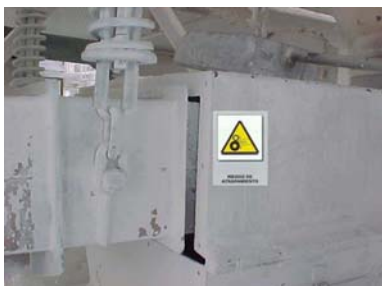
Fotografía nº 15 – ALIMENTADORES/AV-505/AV-506. Señalizar riesgo de atrapamiento.
