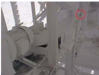
Fotografía nº 5 – SINFIN/SF-2001. Paro de emergencia sin identificar.
