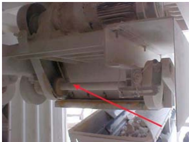
Fotografía nº 19 – ALIMENTADORES EXCÉNTRICOS/AV-110/AV-111. Resguardo insuficiente.
