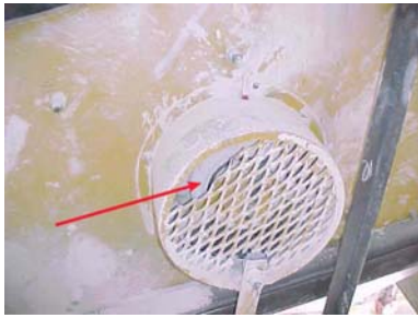
Fotografía nº 9 – CRIBA/CV-551. Resguardo deteriorado.
