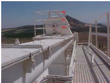
Fotografía nº 67 – ELEVADOR/EC-2201. Faltan barandillas.
