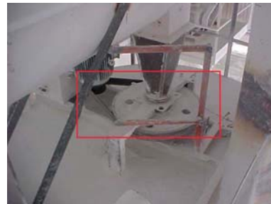
Fotografía nº 44 – SEPARADOR/SE-2018. Falta resguardo de protección.
