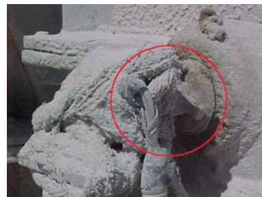
Fotografía nº 6 – HORNO 3/H-3. Envoltorio de cable deteriorada.
