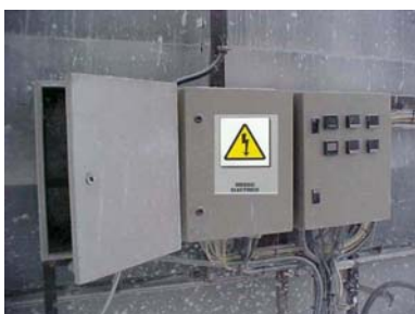
Fotografía nº 23 – HIDRATADORES/H-1/H-2. Falta señalar riesgo eléctrico.
