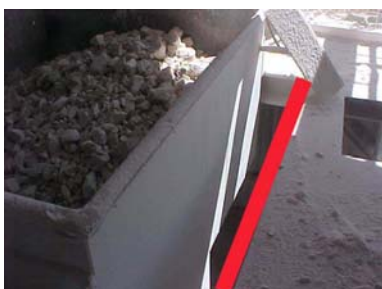
Fotografía nº 23 – TOLVA/TR-109. Faltan rodapiés.
