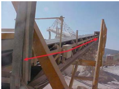
Fotografía nº 3 – CINTA/TC-52. Riesgo de atrapamiento.
