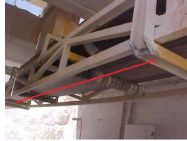
Fotografía nº 10 – CINTA/TC-06. Falta resguardo frente a riesgo de atrapamiento.
