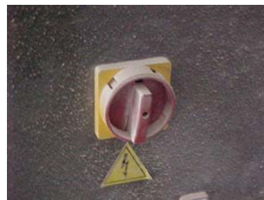
Fotografía nº 8 – CALDERA KONUS. Identificar el interruptor general.
