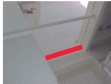
Fotografía nº 12 – SINFÍN/SF-1705. Faltan rodapiés.
