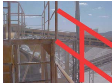
Fotografía nº 6 – CRIBA/CE-04. Elevar barandilla de nivel inferior.
