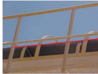
Fotografía nº 44 - CINTA/TC-18. Falta resguardo de protección.
