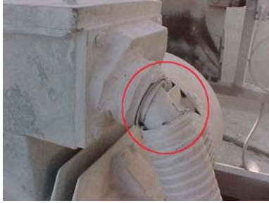
Fotografía nº 9 – VENTILADOR/VFM-H4. Envolvente de cable deteriorada.
