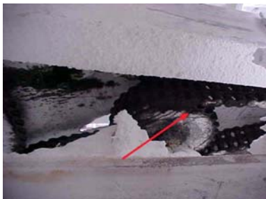
Fotografía nº 21 – HIDRATADORES/H-1/H-2. Resguardo insuficiente.
