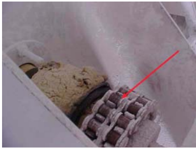
Fotografía nº 57 – SINFÍN/SF-2306. Falta resguardo de protección.
