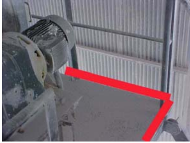
Fotografía nº 25 – ELEVADOR/EC-2013. Faltan rodapiés.
