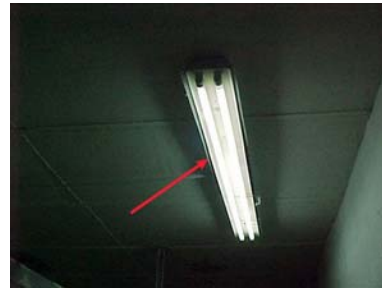
Fotografía nº 10 – COMPRESOR/AC-160. Instalar estanquidad de la luz.
