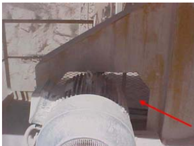
Fotografía nº 29 – MOLINO/MR-14. Resguardo de protección insuficiente.
