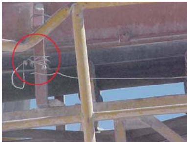
Fotografía nº 5 – CINTA/TC-53. Parada de emergencia deteriorada.
