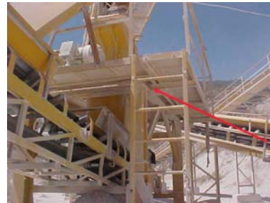
Fotografía nº 38 – MOLINO/MM-20. Falta quitamiedos de protección en la escalera.
