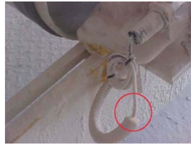
Fotografía nº 18 – CINTA/TC-112. Envoltorio deteriorado.
