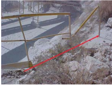
Fotografía nº 1 – ALIMENTADOR/CA-02. Barandillas deterioradas con riesgo de caída a distinto nivel.
