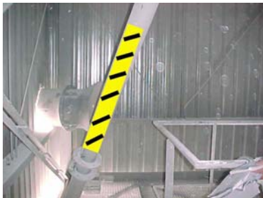
Fotografía nº 11 – VENTILADOR/VFM-1701. Señalizar riesgo de golpeo.
