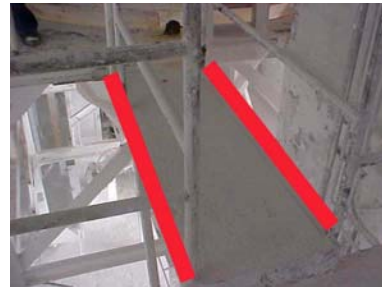
Fotografía nº 30 – SEPARADOR/SE-2015. Faltan rodapiés.
