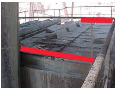
Fotografía nº 3 – VENTILADOR/VFM-H3. Faltan rodapiés.
