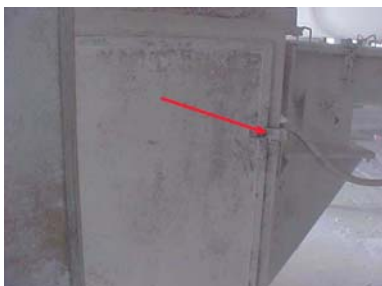
Fotografía nº 79 – ELEVADOR/EC-2101. Falta sistema de enclavamiento en compuerta inspección.
