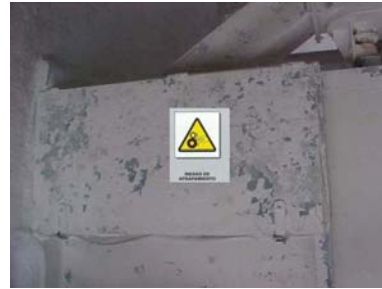
Fotografía nº 28 – ELEVADOR/EC-2013. Existe riesgo de fácil apertura.
