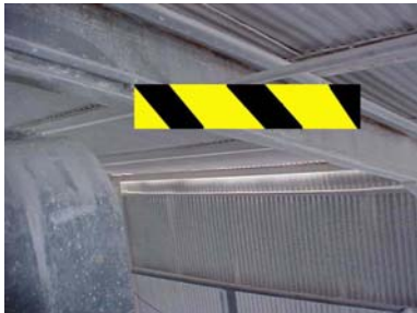
Fotografía nº 29 – ELEVADOR/EC-2013. Riesgo de golpeo en la cabeza.
