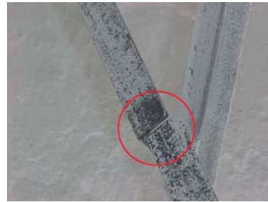
Fotografía nº 18 – CRIBA/CV-600. Reparar tramo intermedio de barandilla.
