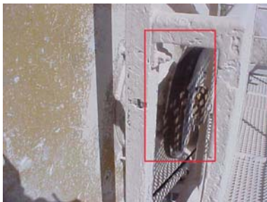
Fotografía nº 13 – CRIBA/CV-155. Resguardo insuficiente.
