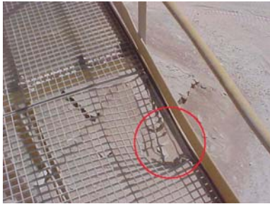
Fotografía nº 11 – CINTA/TC-07. Plataforma de acceso deteriorada.
