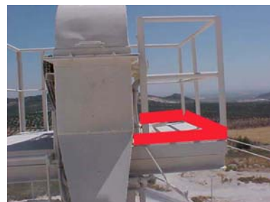
Fotografía nº 80 – ELEVADOR/EC-2101. Faltan rodapiés.
