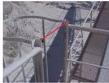
Fotografía nº 12 – CRIBA/CV-155. Falta cadena de protección.
