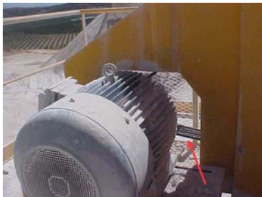
Fotografía nº 27 – MOLINO/MR-14. Resguardo de protección insuficiente.
