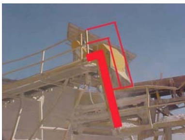
Fotografía nº 7 – CINTA TRANSPORTADORA/TC-53. Falta barandilla en escalera.
