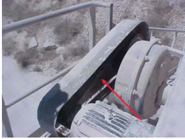
Fotografía nº 33 – CINTA/TC-103. Resguardo insuficiente.
