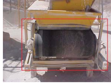
Fotografía nº 18 – CINTA/TC-10. Falta resguardo de protección.
