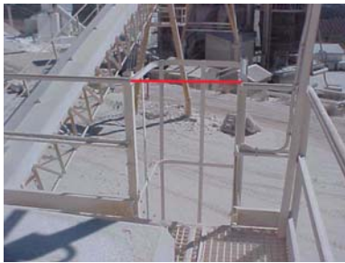
Fotografía nº 11 – CINTA/TC-154. Falta cadena de protección.
