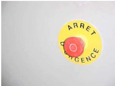
Fotografía nº 1 – CUADRO DE MANDO. Señalizar en castellano.
