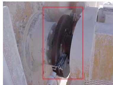
Fotografía nº 14 – CRIBA/CV-155. Falta resguardo.
