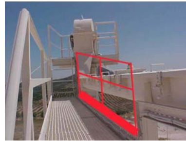
Fotografía nº 82 – ELEVADOR/EC-2101. Falta barandilla a un lado.
