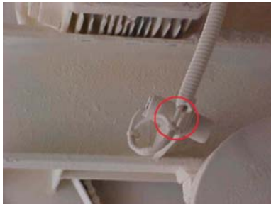
Fotografía nº 17 – ALIMENTADORES/AV-159/AV-160. Envoltorio deteriorado.
