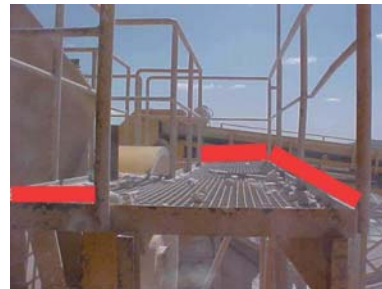
Fotografía nº 4 – CRIBA/CE-04. Faltan rodapiés.
