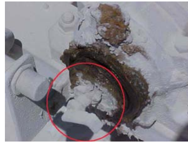
Fotografía nº 74 – SINFÍN/SF-2203. Falta resguardo de protección.
