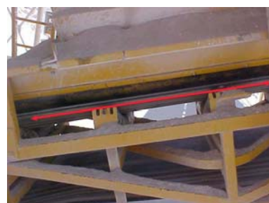
Fotografía nº 32 – CINTA/TC-103. Falta parada de emergencia.
