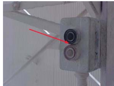
Fotografía nº 84 – SINFÍN/SF-23. Accionamientos sin identificar.
