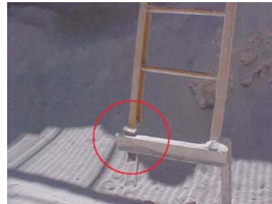
Fotografía nº 22 – CRIBA/CV-11. Escalera sin estabilidad
