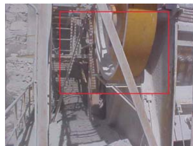
Fotografía nº 16 – MACHACADORA/MM-08. Falta resguardo de protección.
