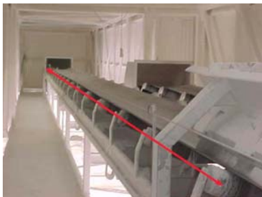
Fotografía nº 29 – CINTA/TC-603. Falta resguardo.
