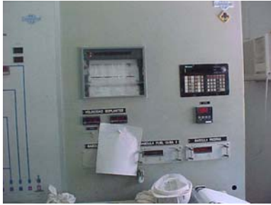
Fotografía nº 1 – CUADRO DE MANDO. Falta parada de emergencia.
