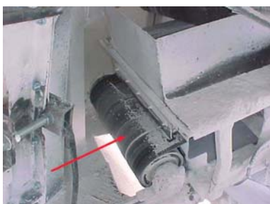
Fotografía nº 31 – CINTA/TC-605. Falta resguardo de protección.
