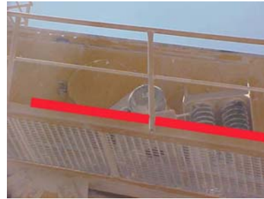
Fotografía nº 20 – CRIBA/CV-11. Faltan rodapiés.
