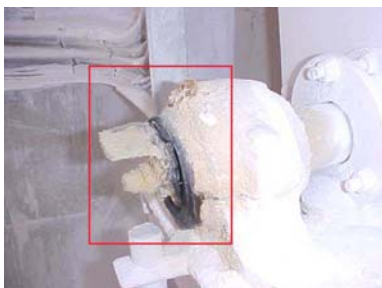
Fotografía nº 55 – SINFÍN/SF-2304. Falta resguardo de protección.
