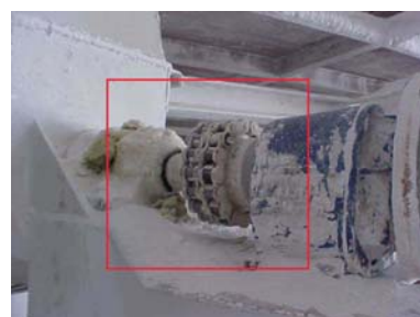
Fotografía nº 24 – SINFÍN/SF-2012. Falta resguardo.
