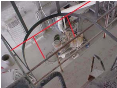
Fotografía nº 33 – SEPARADOR/SE-2015. Falta elevar la barandilla la plataforma a altura de escalera.
