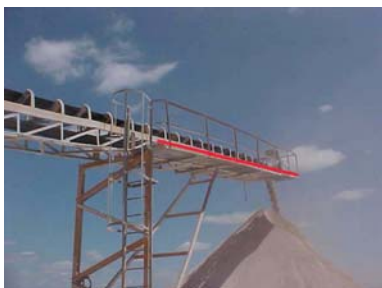
Fotografía nº 47 - CINTA/TC-21. Faltan rodapiés.
