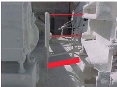
Fotografía nº 13 – CINTA/TC-301. Faltan barandillas.
