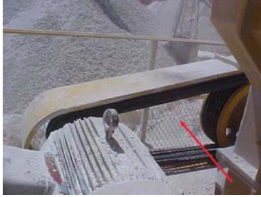
Fotografía nº 41 - MOLINO/MM-20. Resguardo de protección insuficiente.
