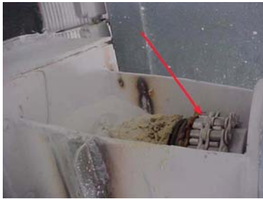
Fotografía nº 41 – SINFÍN/SF-2017. Riesgo de atrapamiento.
