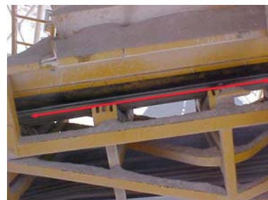
Fotografía nº 32 – CINTA/TC-15. Falta resguardo de protección hasta alcance de la mano.
