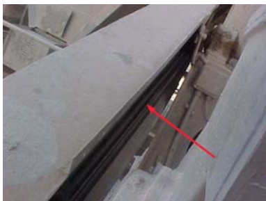
Fotografía nº 7 – VENTILADOR/VFM-H4. Resguardo de protección insuficiente.
