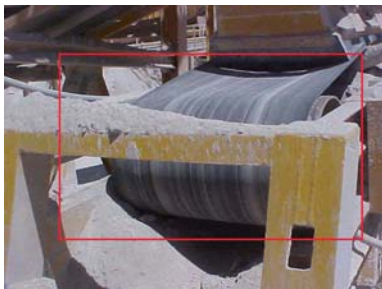
Fotografía nº 45 - CINTA/TC-18. Falta resguardo de protección.
