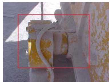
Fotografía nº 40 – MOLINO/MM-20. Falta resguardo de protección.
