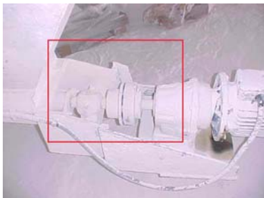
Fotografía nº 13 – SINFÍN/SF-TRSC. Falta resguardo de protección.
