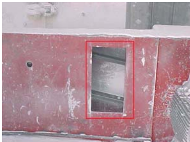
Fotografía nº 5 – MOLINOS/MB-1/MB-2. Resguardo insuficiente.
