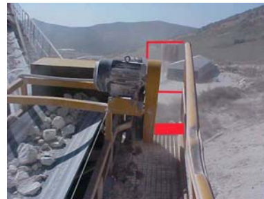
Fotografía nº 4 – CINTA/TC-52. Faltan barandillas al final de la cinta.
