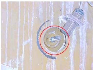
Fotografía nº 7 – TUBO VIBRANTE/TV-550. Resguardo insuficiente
