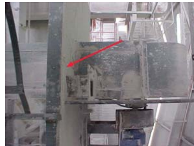
Fotografía nº 36 – ELEVADOR/EC-2016. Faltan elementos de seguridad.
