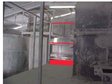
Fotografía nº 38 – ELEVADOR/EC-2016. Señalizar riesgo de tropiezo.
