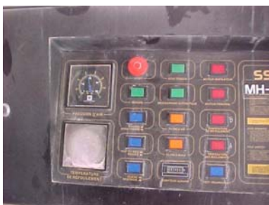
Fotografía nº 7 – COMPRESOR/IR-160. Señalizar los órganos de accionamiento en castellano.
