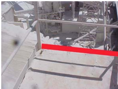
Fotografía nº 27 – CRIBA/CV-104. Faltan rodapiés.
