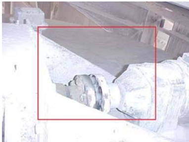
Fotografía nº 53 – SINFÍN/SF-2021. Falta resguardo de protección.
