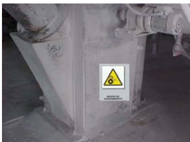
Fotografía nº 39 – ELEVADOR/EC-2016. Falta sistema de enclavamiento en el resguardo y señalizar.
