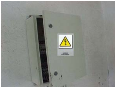
Fotografía nº 3 – BOMBA/BD-01. Señalizar riesgo eléctrico.
