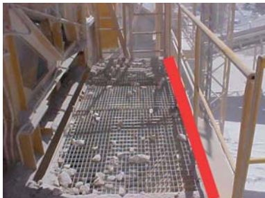
Fotografía nº 5 – CRIBA/CE-04. Faltan rodapiés.
