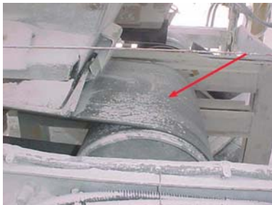
Fotografía nº 27 – CINTA/TC-603. Falta resguardo.
