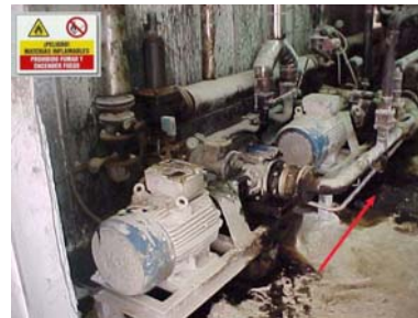
Fotografía nº 4 – BOMBA BG-01. Instalar un sistema de recogida de fueloil adecuado y señalizar riesgo.
