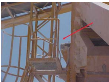
Fotografía nº 23 – CRIBA/CV-11. Huecos en la barandilla.
