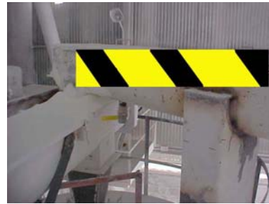
Fotografía nº 42 – SINFÍN/SF-2017. Señalizar riesgo de golpeo en la cabeza.
