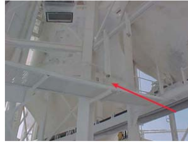
Fotografía nº 2 – ALIMENTADOR/AV-1200. Faltan elementos de seguridad en las plataformas de acceso.
