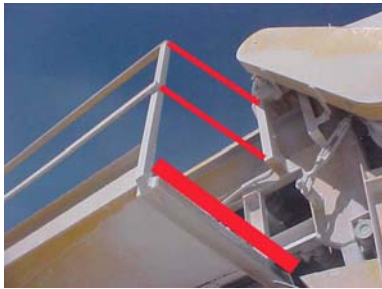
Fotografía nº 25 – CINTA/TC-13. Faltan barandillas.
