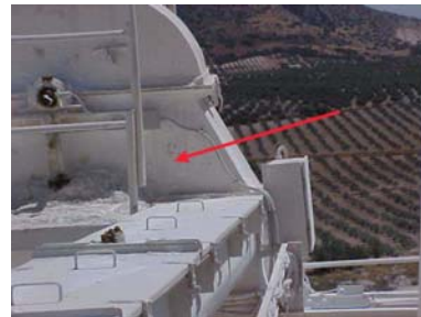
Fotografía nº 68 – ELEVADOR/EC-2201. Acceso a transmisión de elevador inadecuado.
