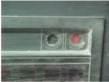
Fotografía nº 11 – COMPRESOR/AC-1210. Señalizar los órganos de accionamiento.
