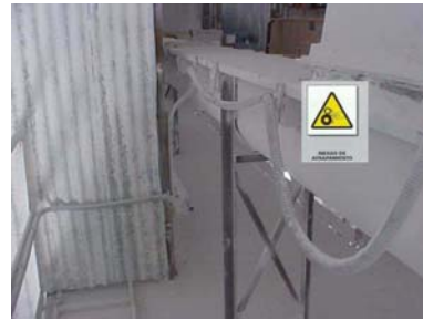
Fotografía nº 58 – SINFÍN/SF-2306. Señalizar riesgo de atrapamiento y golpeo en cabeza al pasar.
