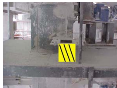
Fotografía nº 40 – ELEVADOR/EC-2016. Señalizar riesgo de tropiezo.
