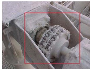
Fotografía nº 4 – SINFIN/SF-ALV. Falta resguardo de protección.
