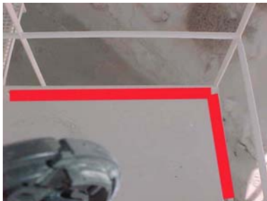
Fotografía nº 11 – CINTA/TC-301. Faltan rodapiés.
