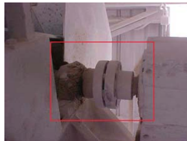
Fotografía nº 22 – CINTA/TC-161. Falta resguardo de protección.
