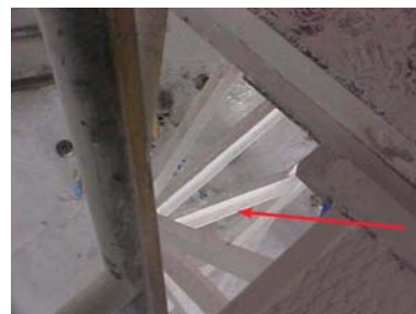
Fotografía nº 32 – SEPARADOR/SE-2015. Huevo con riesgo de caída.
