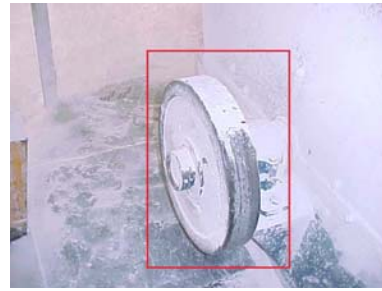
Fotografía nº 10 – MOLINO/MM-558. Falta resguardo de protección.
