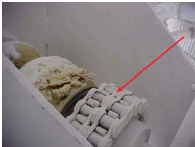
Fotografía nº 59 – SINFÍN/SF-2307. Falta resguardo de protección.
