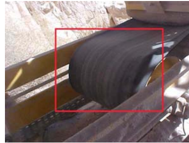
Fotografía nº 12 – CINTA/TC-07. Falta resguardo de protección.
