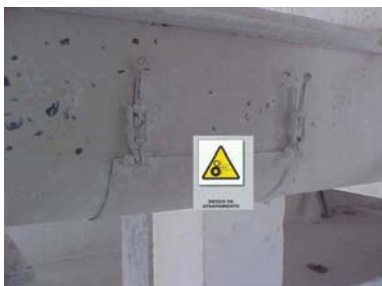
Fotografía nº 87 – SINFÍN/SF-2011. Señalar riesgo de atrapamiento en compuerta de descarga rápida.
