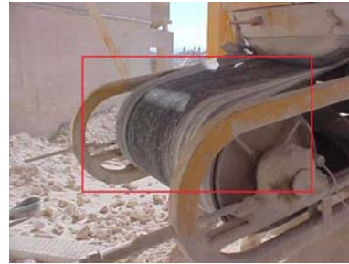
Fotografía nº 2 – CINTA/TC-52. Riesgo de atrapamiento.
