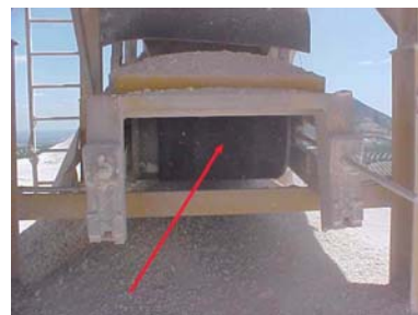
Fotografía nº 48 - CINTA/TC-21. Falta resguardo.
