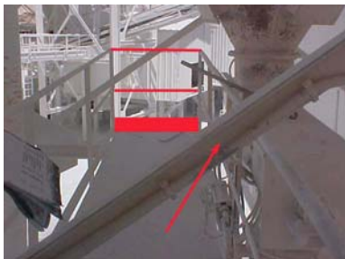
Fotografía nº 85 – SINFÍN/SF-21. Falta barandilla de protección y señalar riesgo de golpeo.
