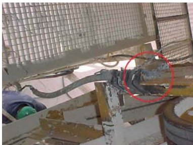
Fotografía nº 21 – CRIBA/CV-600. Envolventes de cables deterioradas.
