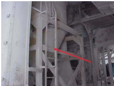
Fotografía nº 43 – SEPARADOR/SE-2018. Falta quitamiedos en escalera de gato.
