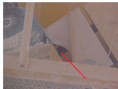
Fotografía nº 24 – CRIBA/CV-11. Resguardo insuficiente.
