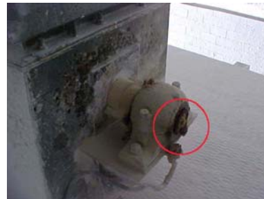
Fotografía nº 20 – HIDRATADORES/H-1/H-2. Falta resguardo.
