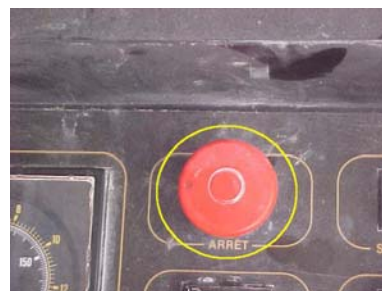
Fotografía nº 8 – COMPRESOR/IR-160. Falta fondo amarillo y señalar p. de emergencia en castellano.
