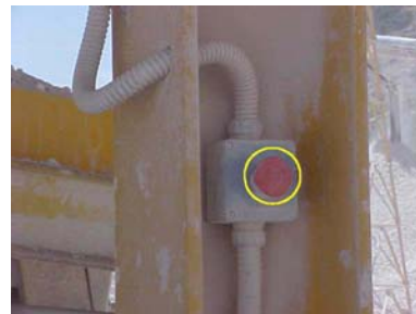
Fotografía nº 46 - CINTA/TC-21. Falta señalar la parada de emergencia.
