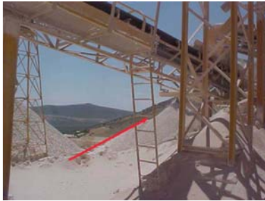
Fotografía nº 43 - CINTA/TC-18. Falta quitamiedos de protección en la escalera.
