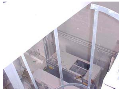
Fotografía nº 62 – VENTILADOR/VF-2353. Quitamiedos de escalera deteriorado.
