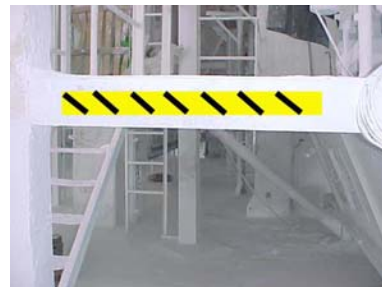
Fotografía nº 14 – SINFÍN/SF-TRSC. Señalizar riesgo de golpeo.
