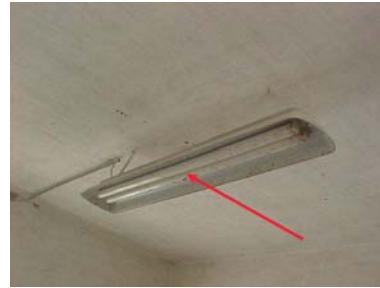
Fotografía nº 2 – BOMBA/BD-01. Reparar estanqueidad de la luz.
