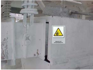
Fotografía nº 1 – ALIMENTADORES/AV-507/AV-508. Señalar riesgo de atrapamiento.
