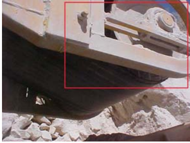
Fotografía nº 9 – CINTA/TC-06. Falta resguardo frente a riesgo de atrapamiento.
