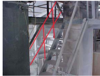
Fotografía nº 18 – HIDRATADORES/H-1/H-2. Falta barandilla izquierda de la escalera.
