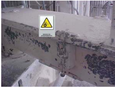
Fotografía nº 11 – SINFÍN/SF-2006. Señalizar riesgo de atrapamiento.
