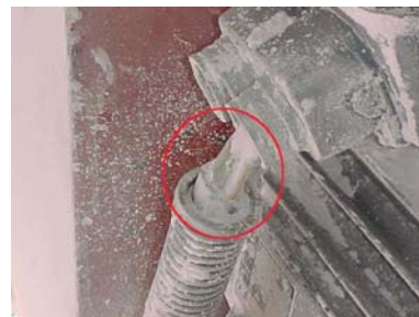
Fotografía nº 8 – MOLINOS/MB-1/MB-2. Envolventes de cables deteriorados.
