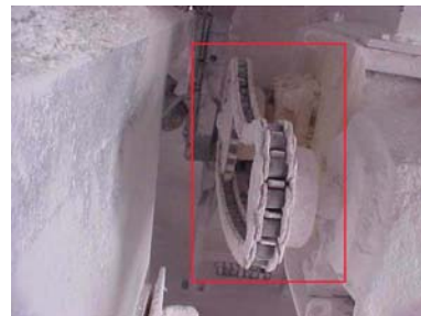
Fotografía nº 78 – SINFÍN/SF-2100. Falta resguardo de protección.
