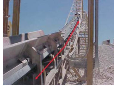
Fotografía nº 34 – CINTA/TC-17. Falta resguardo de protección.
