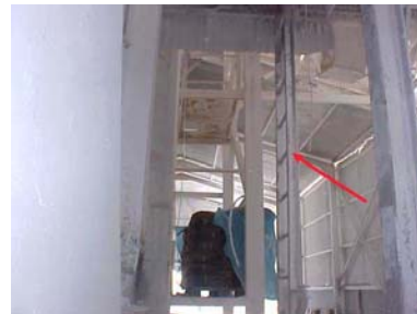
Fotografía nº 60 – VENTILADOR/VF-2700. Falta quitamiedos en escalera vertical.
