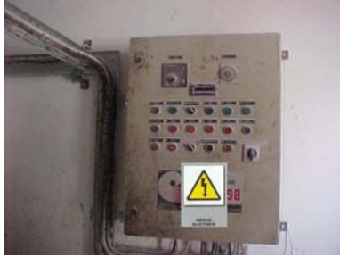
Fotografía nº 9 – CALDERA ERATCISA. Señalizar riesgo eléctrico.
