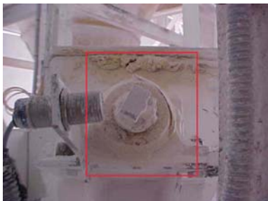
Fotografía nº 45 – SINFÍN/SF-2019. Falta resguardo de protección.
