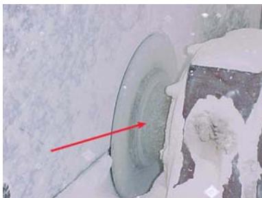
Fotografía nº 7 – MOLINOS/MB-1/MB-2. Falta resguardo.
