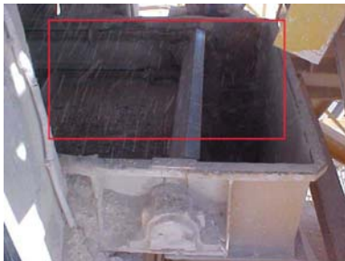
Fotografía nº 3 – RASCADOR/RC-03. Riesgo de atrapamiento.
