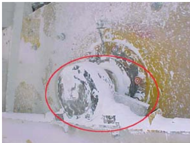
Fotografía nº 19 – CRIBA/CV-600. Falta resguardo de protección.
