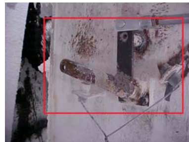
Fotografía nº 22 – HIDRATADORES/H-1/H-2. Falta resguardo.
