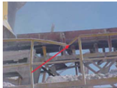
Fotografía nº 6 – CINTA/TC-53. Parada de emergencia deteriorada.
