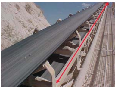
Fotografía nº 13 – CINTA/TC-07. Falta resguardo de protección.
