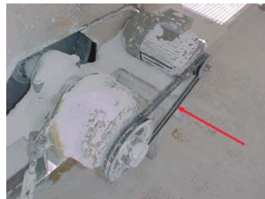
Fotografía nº 30 – CINTA/TC-603. Falta resguardo.
