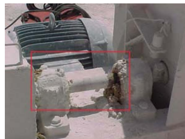
Fotografía nº 24 – VENTILADOR/VFM-6000. Resguardo insuficiente.
