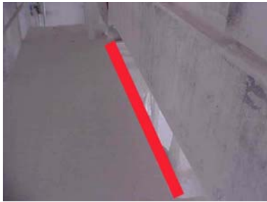
Fotografía nº 17 – HIDRATADORES/H-1/H-2. Faltan rodapiés.
