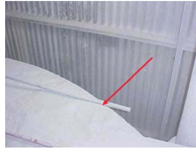
Fotografía nº 52 – SINFÍN/SF-2021. Barandilla deteriorada.
