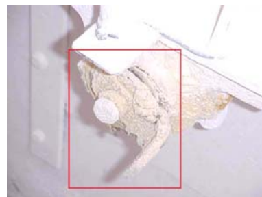
Fotografía nº 56 – SINFÍN/SF-2305. Falta resguardo de protección.
