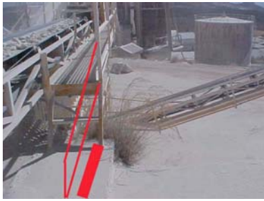
Fotografía nº 9 – CINTA/TC-154. Falta barandilla.
