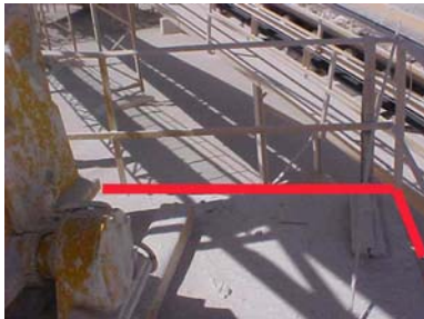
Fotografía nº37 – MOLINO/MM-20. Faltan rodapiés.
