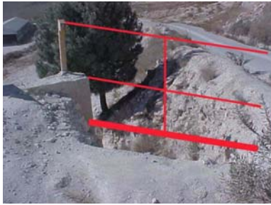
Fotografía nº 1 _ TOLVA RECEPCIÓN/TR-P. Faltan barandillas existiendo riesgo de caída a distinto nivel.
