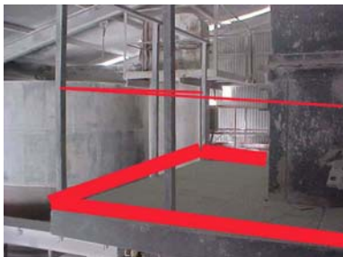
Fotografía nº 37 – ELEVADOR/EC-2016. Faltan rodapiés y barra intermedia.
