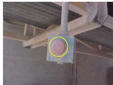
Fotografía nº 8 – CINTA/TC-06. Falta fondo amarillo señalizando la parada de emergencia.
