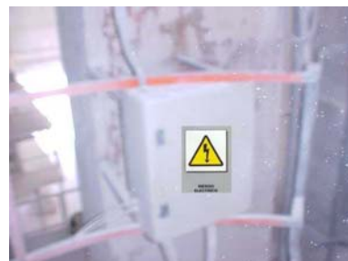
Fotografía nº 64 – VENTILADOR/VF-2353. Señalizar riesgo eléctrico.
