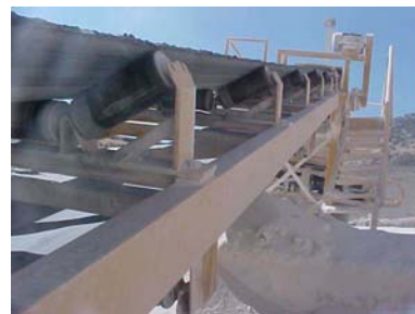
Fotografía nº 8 – CINTA /TC-53. Falta parada de emergencia..
