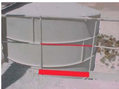
Fotografía nº 23 – VENTILADOR/VFM-6000. Zonas desprotegidas con riesgo de caída a distinto nivel.
