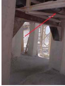
Fotografía nº 17 – CINTA/TC-09. Falta resguardo de protección.
