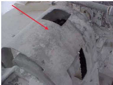
Fotografía nº 19 – HIDRATADORES/H-1/H-2. Resguardo insuficiente.
