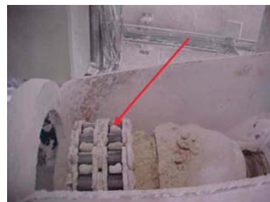
Fotografía nº 88 – SINFÍN/SF-2355. Falta resguardo de protección.
