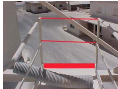
Fotografía nº 76 – SINFÍN/SF-23. Faltan barandillas.
