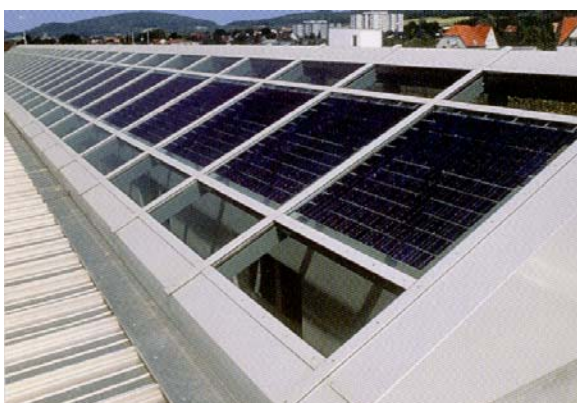
Figura 2.3.2.1.1. Tejado solar. Fuente: SOLARSHADE
