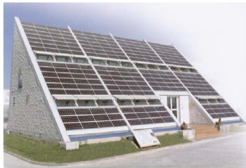
Fuente: Ingecon Sun
