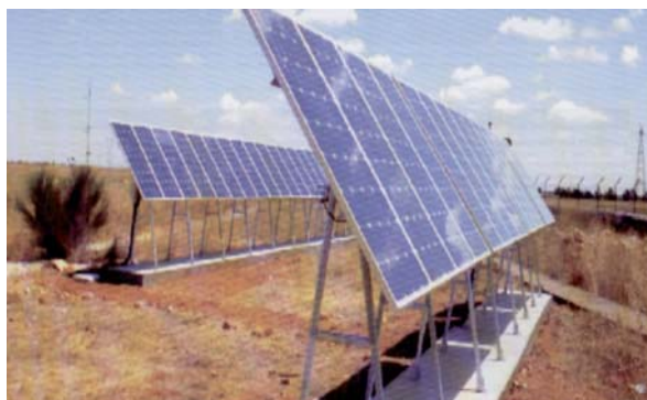
Figura 2.4.1. Instalaciones F.V. conectadas a red. Fuente: ERA SOLAR
